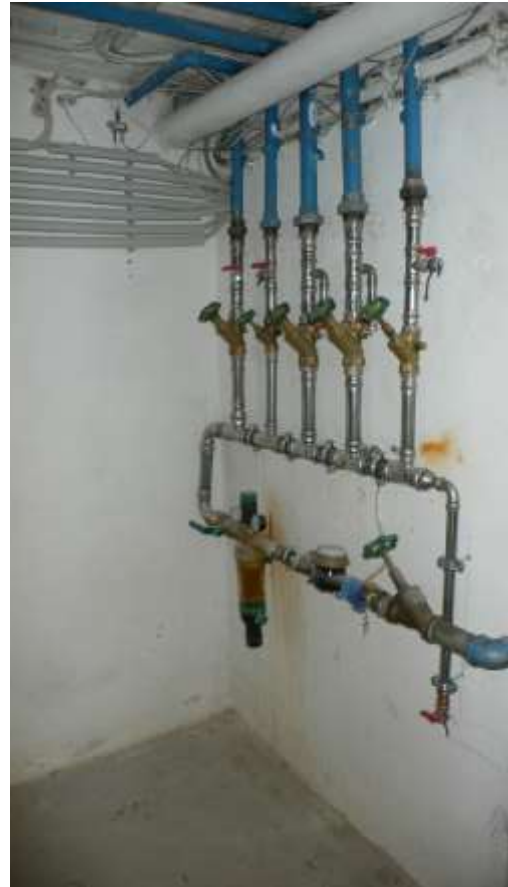
Bild 21: Wasserinstalation im KG
