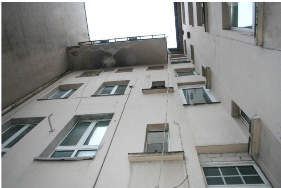
Bild 12: Südwestansicht / schadhafter Balkon
