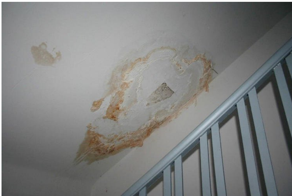
Bild 20: Feuchtigkeitsschaden im Treppenhaus
