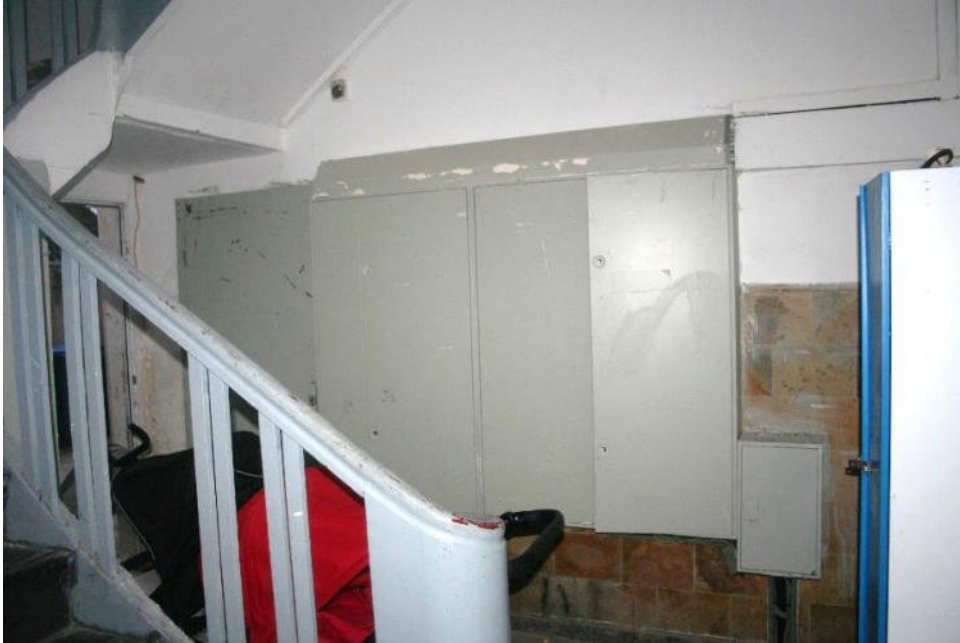
Bild 15: Hausflur mit Elektrounterverteilung
