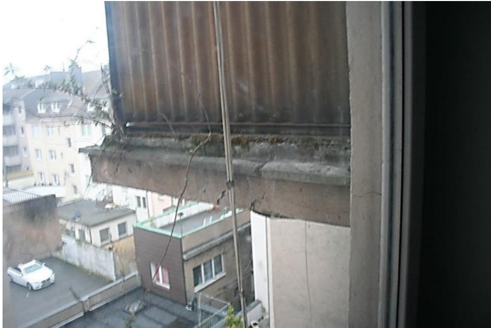
Bild 19: schadhafter Balkon im 4. OG
