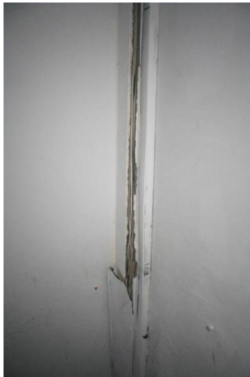
Bild 18: Schäden im Treppenhaus
