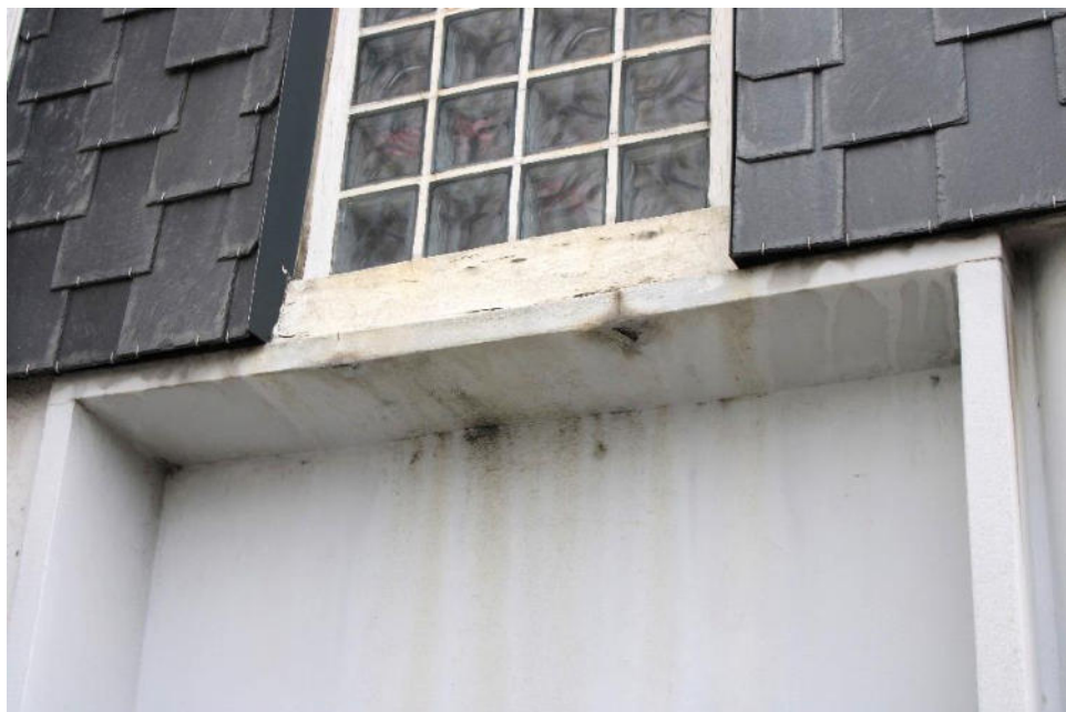
Bild 6: Detailfoto Schäden / Feuchtigkeitseinwirkungen
