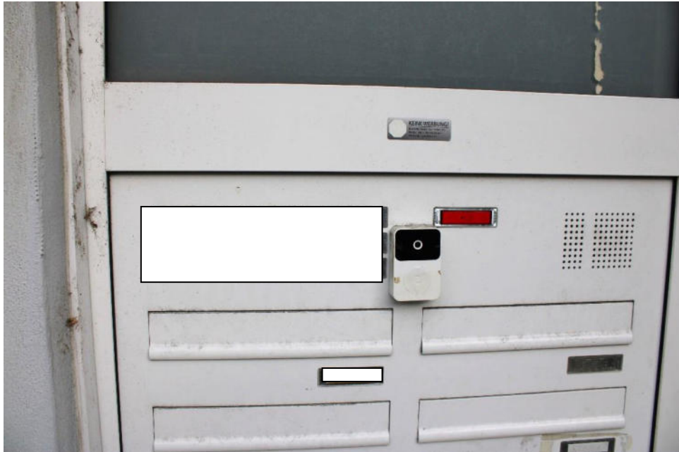
Bild 11: Klingel- / Gegensprech- und Briefkastenanlage des Gebäudes
