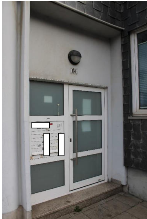
Bild 10: Hauseingangtür Gebäude Enneper Str. 156
