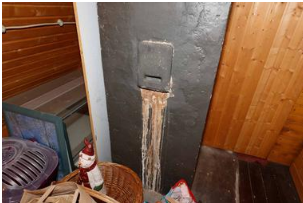
Foto Nr. 23 Spitzboden: Kamin mit Versottungsschäden
