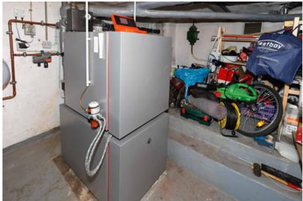
Foto Nr. 9 KG: Heizungskeller
