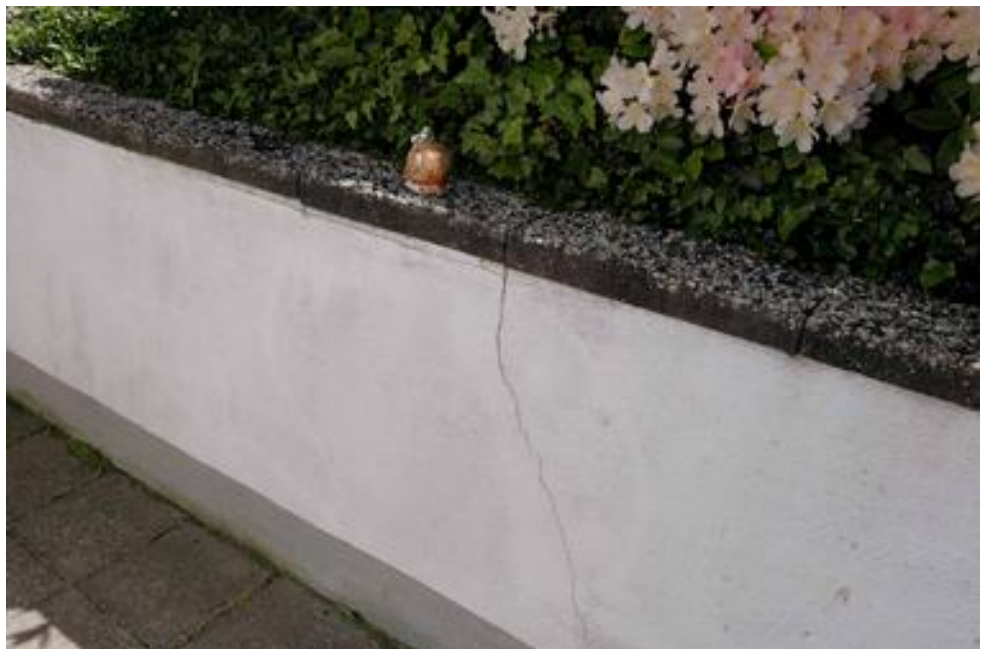
Foto Nr. 8 Stützmauer an der Südgrenze
