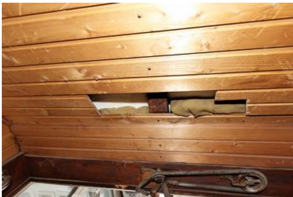
Foto Nr. 24 Spitzboden Detail: Dachschrägen mit unzureichender, provisorischer Dämmung
