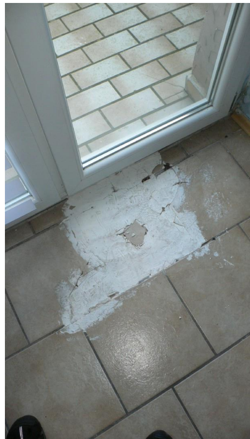
Bild 34: Balkontür mit Reparatur
