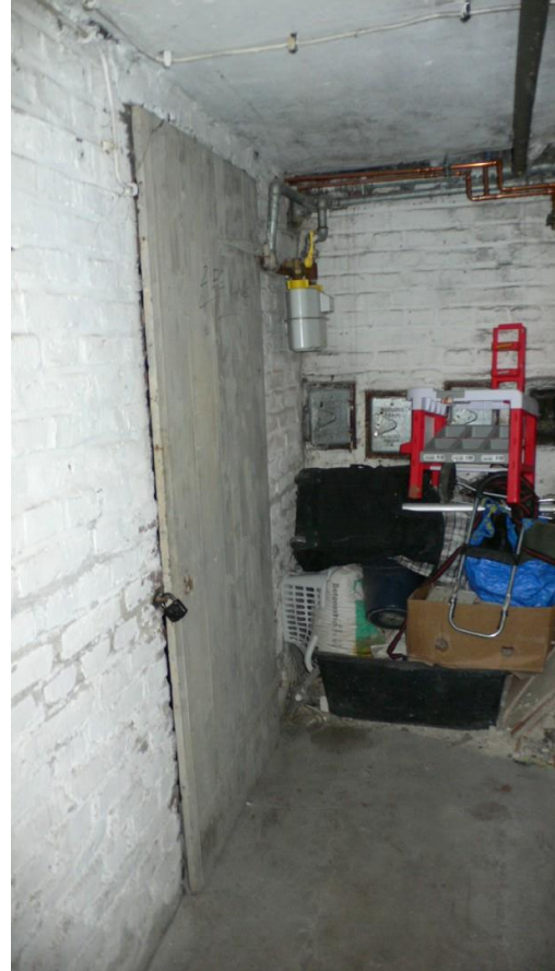
Bild 24: KG mit Gaszähler
