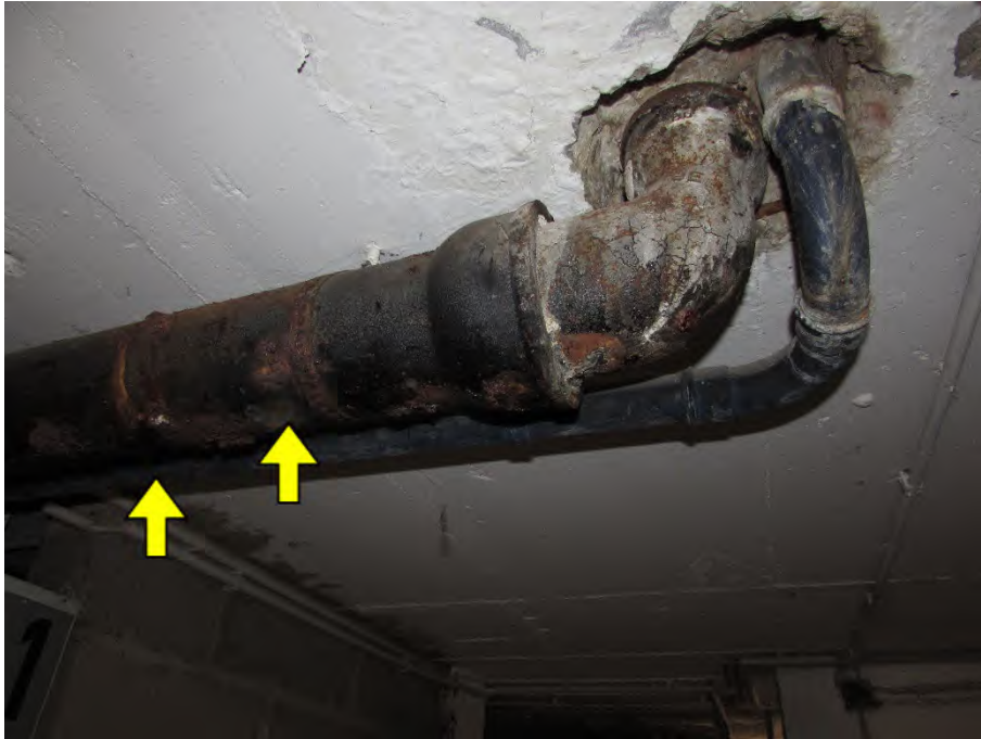
Foto 13: Kellergeschoss: alte, korrodierte Gußentwässerung
