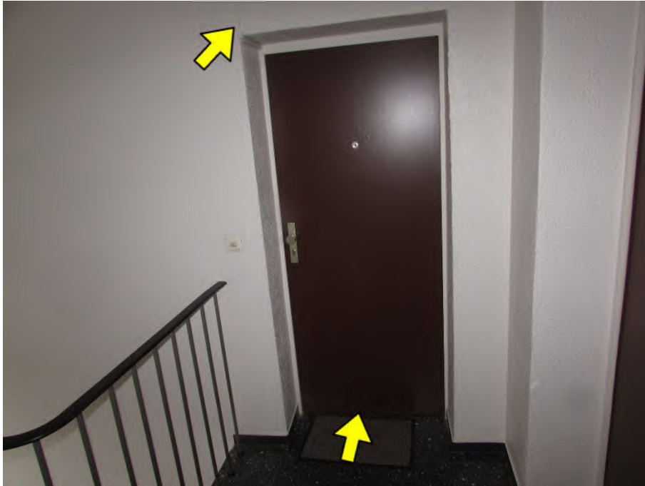
Foto 11: Zugang zu der zu bewertenden Wohnung Nr. 44: nicht ordnungsgemäß verlegte Intallation in die zu bewertende Wohnung
