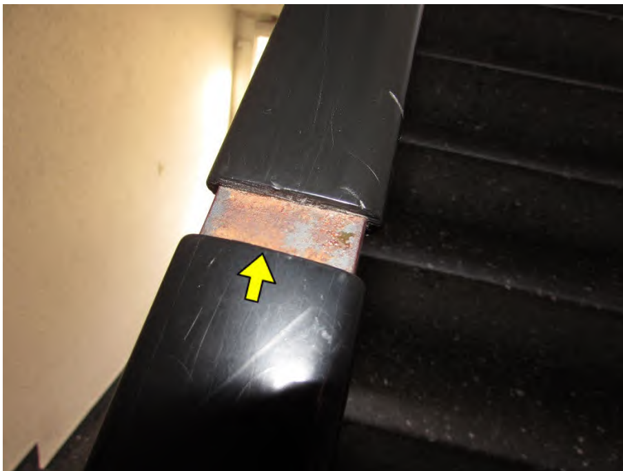
Foto 10: Treppenhaus: schadhafter Treppenhandlauf
