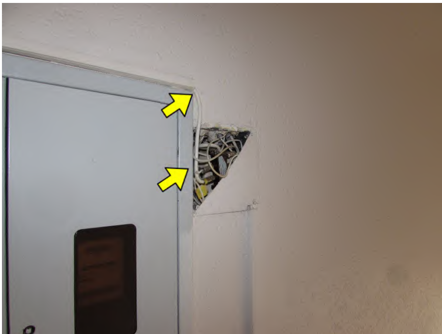
Foto 12: Treppenhausflur: nicht ordnungsgemäß verlegte Intallation in die zu bewertende Wohnung
