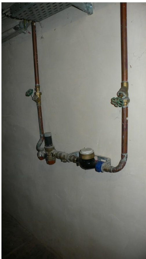
Bild 24: Wasserzähler im KG
