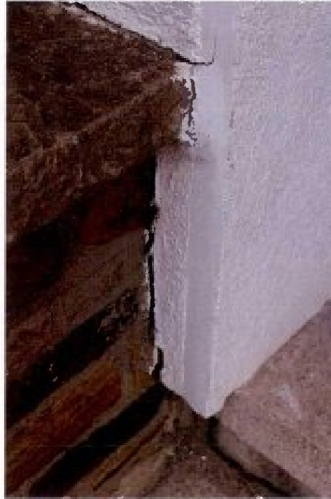
Bild 15: defekter Sockel neben der Hauseingangstür
