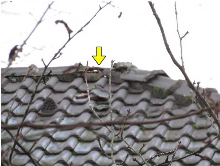
Foto 2: Beschädigung im Firstziegel-Bereich
