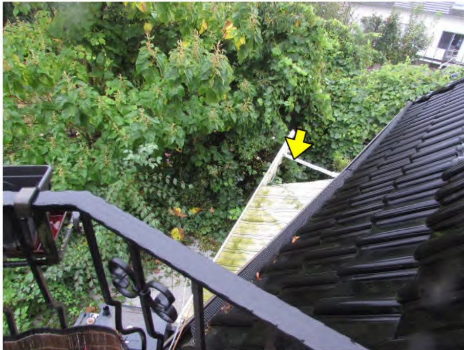
Foto 7: erneuerungsbedürftige, zerrissene Markise
