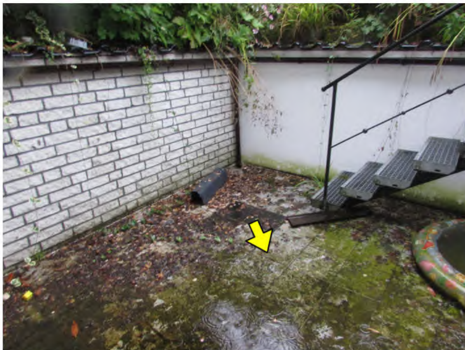
Foto 8: Wohnung 1, Kellergeschoss, Terrasse 1: stehendes Wasser, überprüfungsbedürftige Entwässerung
