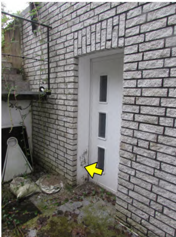
Foto 6: Wohnhaus, Kelleraußentür: Feuchtigkeit im Türлаибungsbereich
