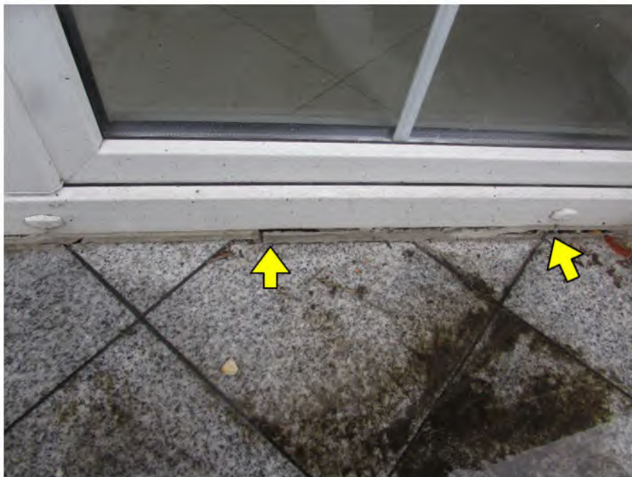
Foto 10: Wohnung 1, Erdgeschoss, (Dach-)Terrasse 2: beschädigte, undichte Anschlussfugen
