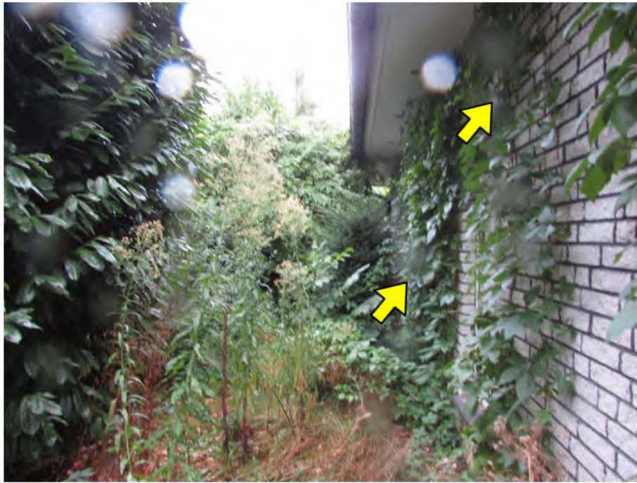
Foto 3: Wohnhaus: verwilderte Eingrünung auf der Fassade
