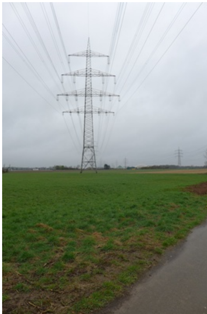
Hochspannungsleitungen - etwa Richtung Norden
