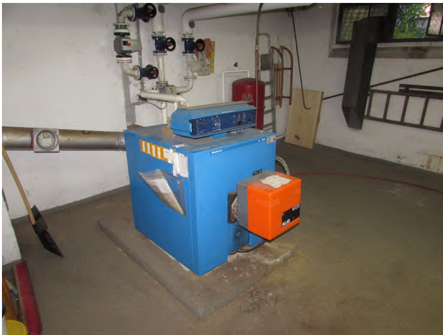
Foto 10: Kellergeschoss, Heizungskeller: überalterter Heizkessel
