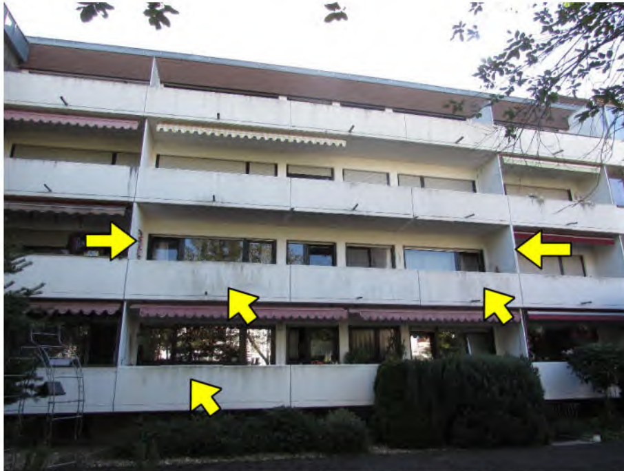
Foto 3: Mehrfamilienhaus "Mittelstraße 44", Hofansicht, zu bewertende Wohnung Nr. 5: fleckige Loggia-Brüstungen
