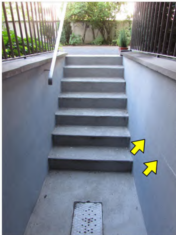
Foto 4: Kelleraußentreppe: Putzrisse im Stützwandbereich
