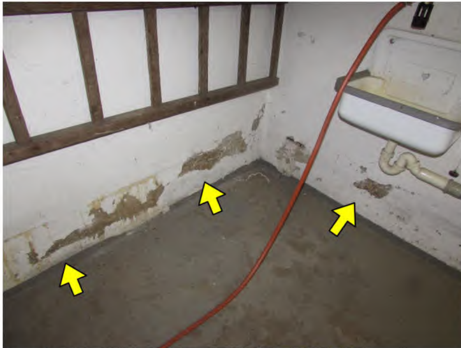
Foto 11: Kellergeschoss, Heizungskeller: Feuchtigkeit im Wandbereich
