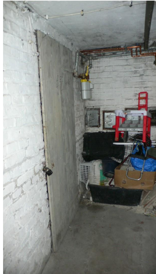
Bild 24: KG mit Gaszähler
