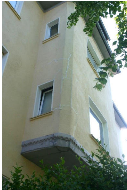
Bild 5: Detailfoto Erker zur Königstraße / verpresste Rissbildungen
