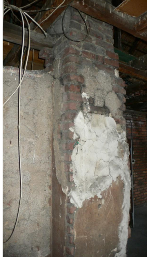
Bild 40: Kamin im Dachraum
