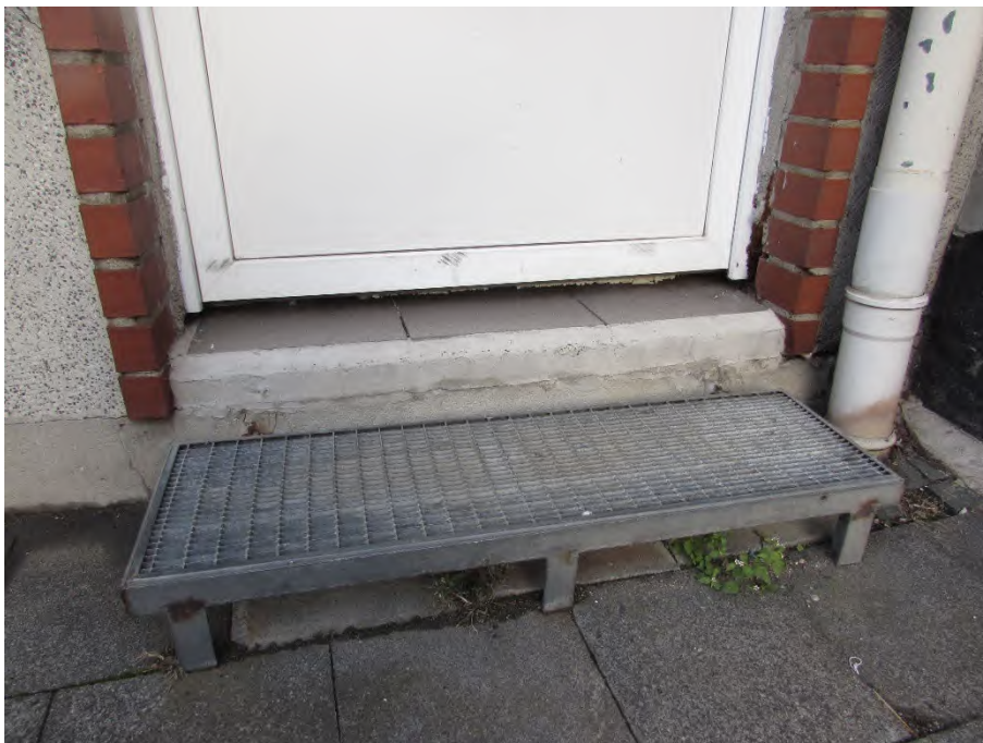
Foto 14: undichte Hauseingangstür / Hauseingangsstufe
