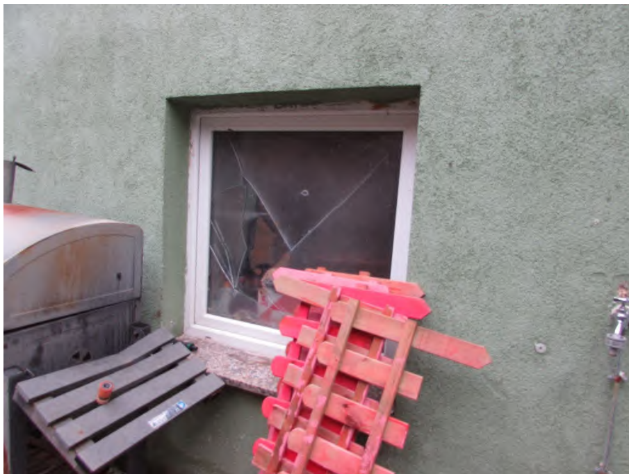
Foto 12: beschädigte Glasscheibe (EG)
