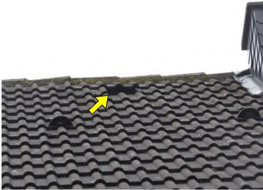
Foto 5: Wohnhaus: tlw. fehlende Betondachsteine
