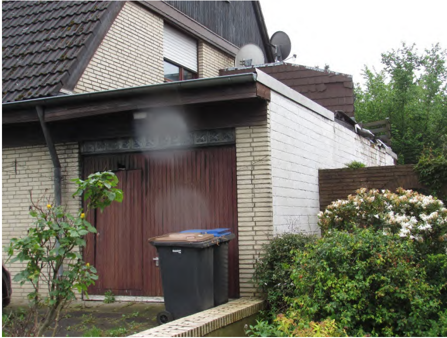
Foto 7: nach Brand baufällige PKW-Doppelgarage
