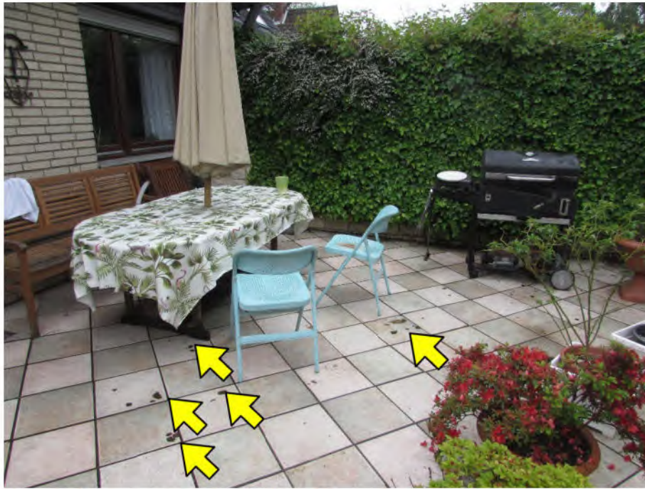
Foto 9: Terrasse mit schadhaftem Fliesenbelag
