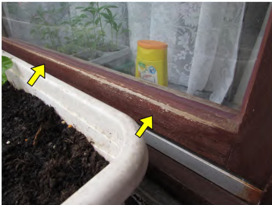
Foto 6: Wohnhaus: verwitterte Holzfenster
