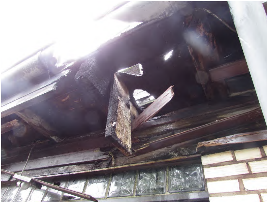
Foto 8: nach Brand baufällige PKW-Doppelgarage
