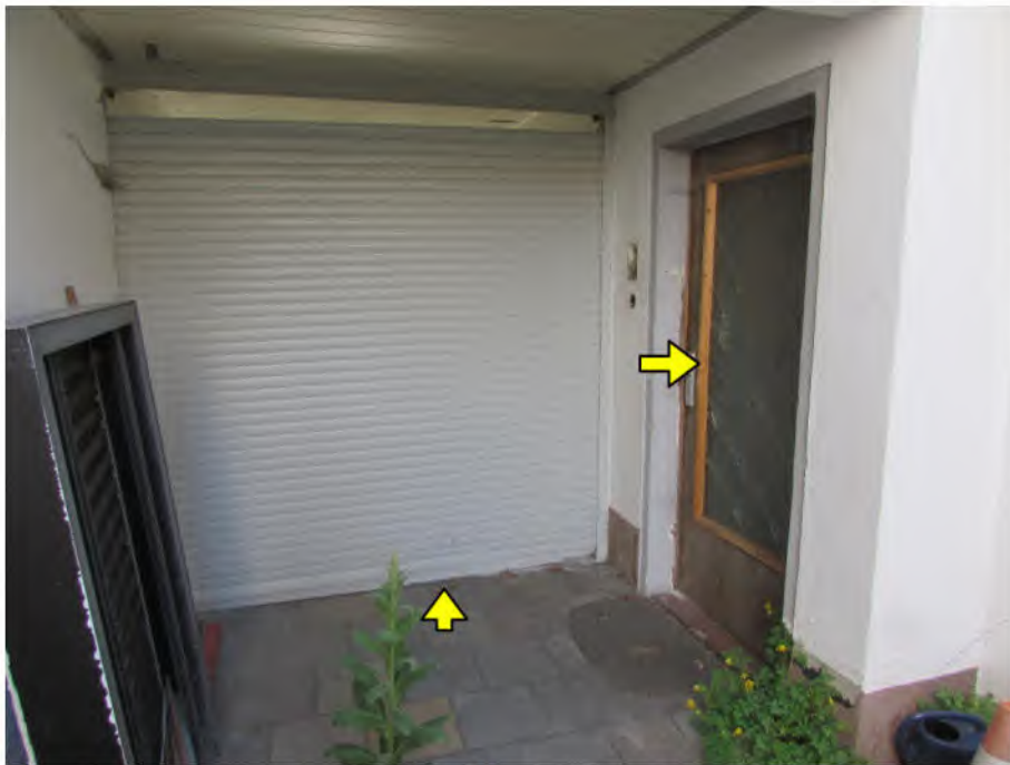
Foto 6: Garagentor, beschädigte Hauseingangstür
