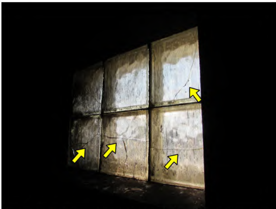
Foto 30: wohnraumähnlich ausgebautes Dachgeschoss: gerissene Glasbausteinfenster
