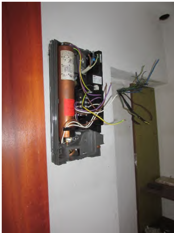
Foto 16: Erdgeschoss: beschädigte Elektroinstallationen, hier Durchlauferhitzer
