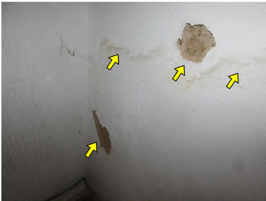
Foto 10: Kellergeschoss, Kellerabgang: Feuchtigkeit und Putzschäden im Wandbereich
