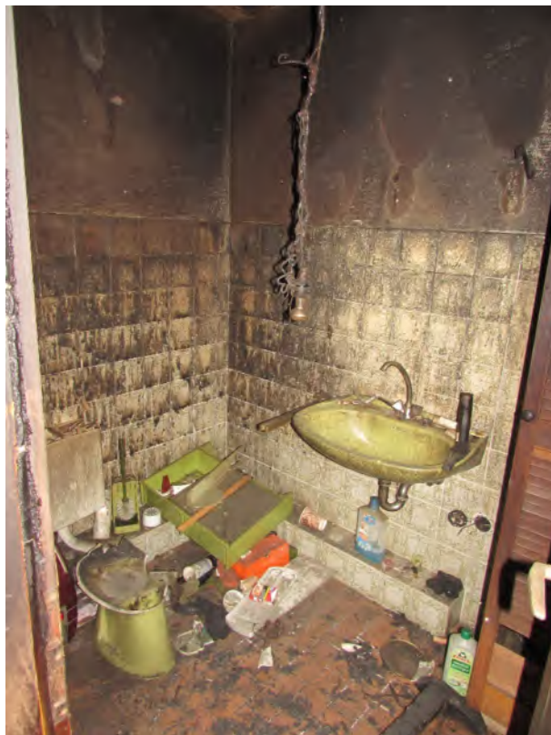
Foto 22: Obergeschoss, Duschbad: Brandschaden
