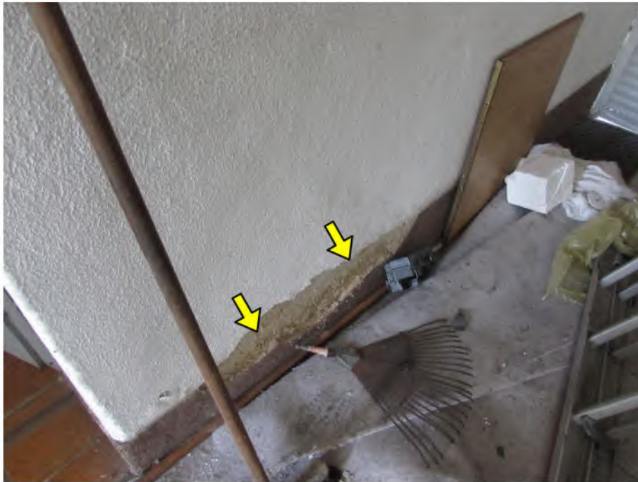
Foto 13: Erdgeschoss, Garage: Feuchtigkeit und Putzschäden im Wandbereich
