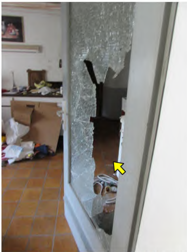
Foto 14: Erdgeschoss, Garage: beschädigte Zugangstür zur Waschküche
