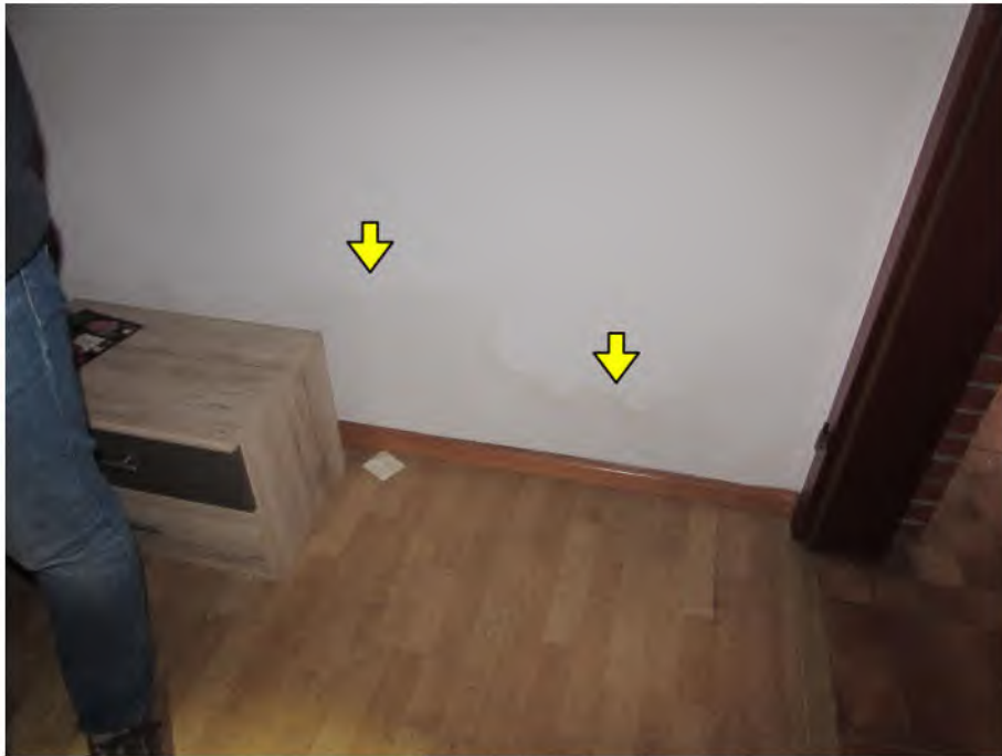
Foto 19: Erdgeschoss: Feuchtigkeit im Wandbereich
