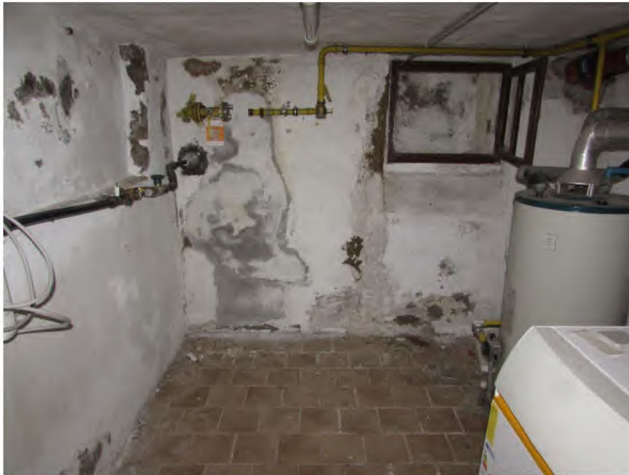
Foto 11: Kellergeschoss, Heizungskeller: Feuchtigkeit im Wandbereich
