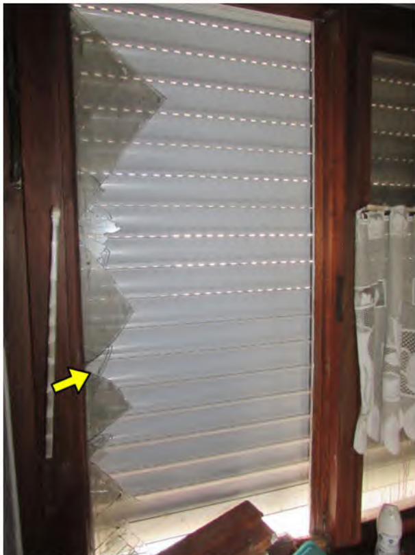
Foto 26: Obergeschoss: beschädigte Fensterscheibe
