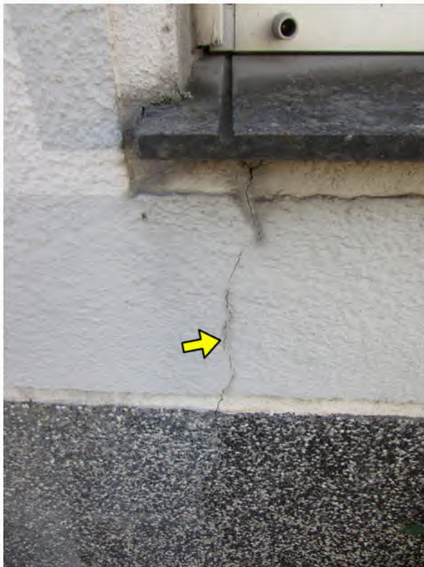
Foto 8: Ansicht von der "Ulrichstraße": Risse im Fassadenputz
