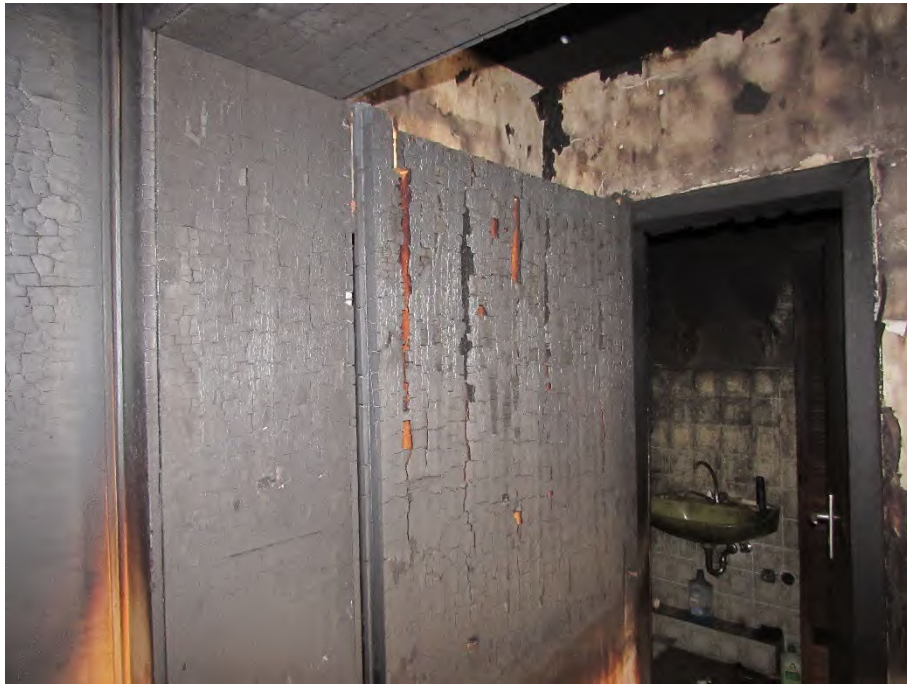
Foto 21: Obergeschoss, Küche: Brandschaden
