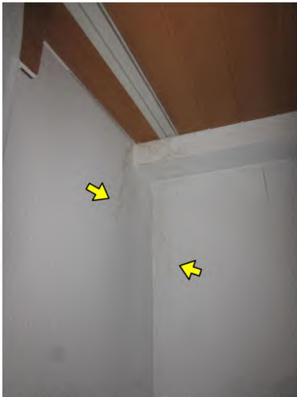
Foto 18: Erdgeschoss, Abstellraum: Feuchtigkeitsfleck
