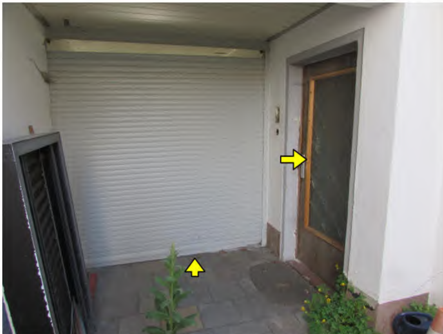
Foto 6: Garagentor, beschädigte Hauseingangstür
