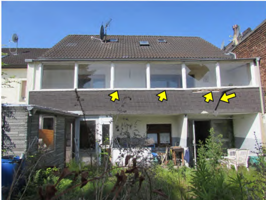
Foto 9: gartenseitige Ansicht: beschädigte Verkleidung der Balkonbrüstung, verwitterte Holzfenster
