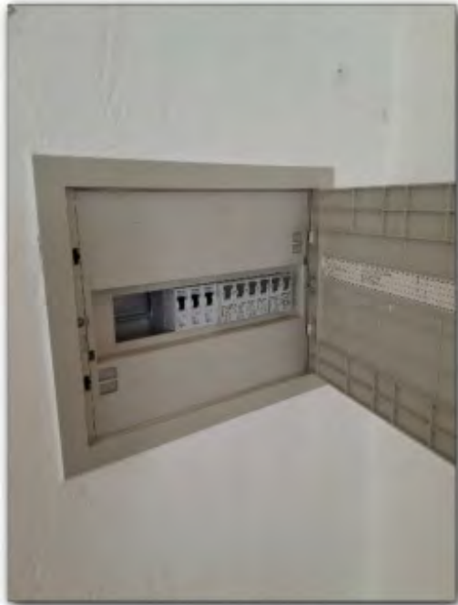
Foto 29: OG - Unterverteilung im Schlafzimmer
