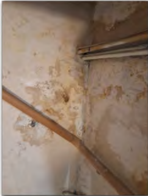
Foto 05: Feuchteschäden an Kelleraußenwänden
