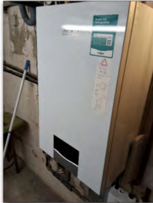
Foto 06: Heizungstherme 1 im Kellerflur
