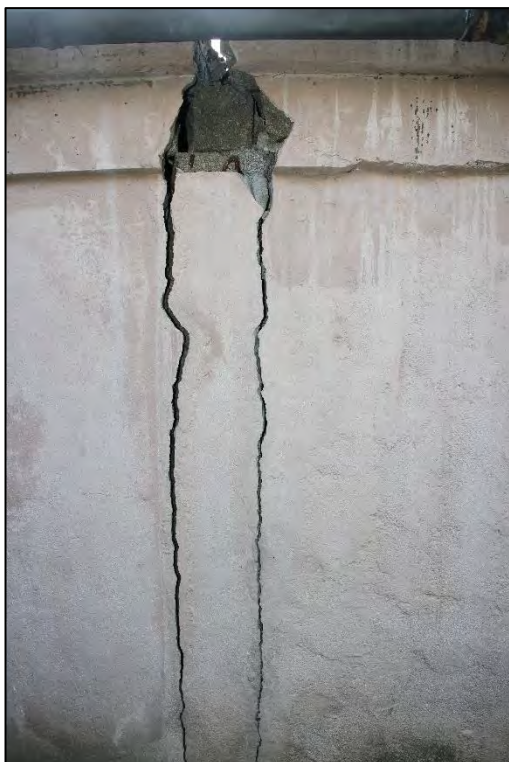
Foto Nr. 10: Garagenfassade / Rissbildung
