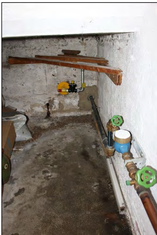
Foto Nr. 26: Kellergeschoss, Hausanschlüsse
