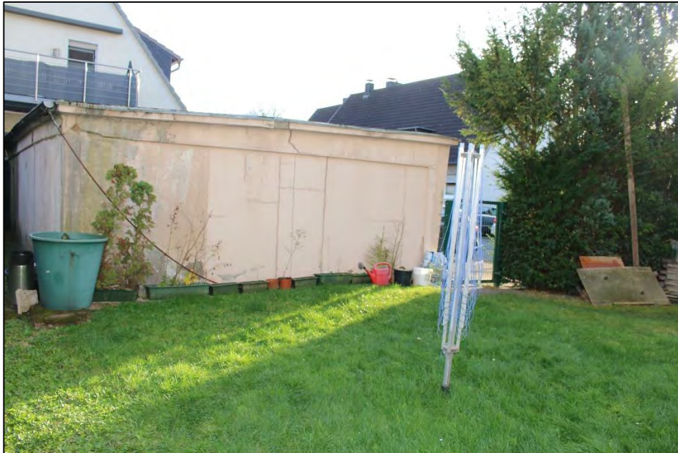
Foto Nr. 9: Seitenfassade Garagen / Rissbildung
