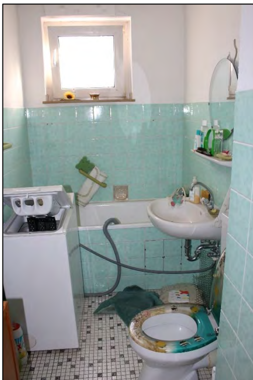
Foto Nr. 40: Erdgeschoss rechts, WE Nr. 2, Bad
