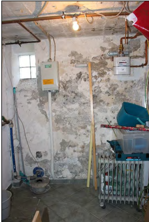
Foto Nr. 21: Kellergeschoss, Flur / Feuchtschäden, Hausanschlüsse
