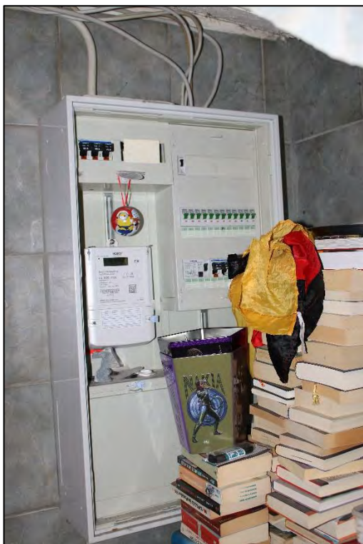
Foto Nr. 22: Kellergeschoss, Elektrounterverteilung
