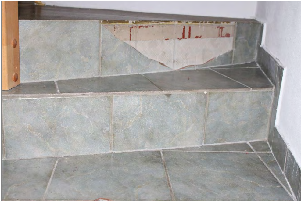
Foto Nr. 19: schadhafte Fliesen / Treppenabgang
