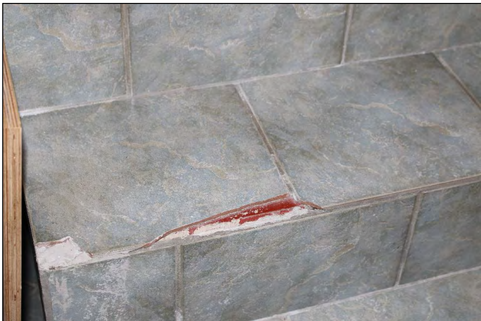
Foto Nr. 20: schadhafte Fliesen / Treppenabgang
