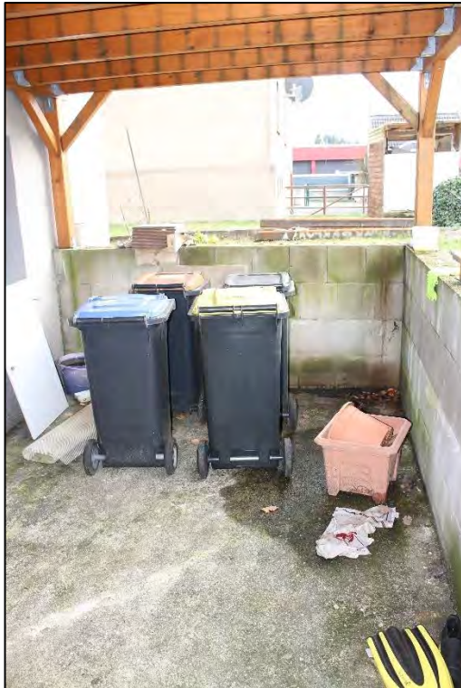
Foto Nr. 7: Fläche unterhalb des Balkons
