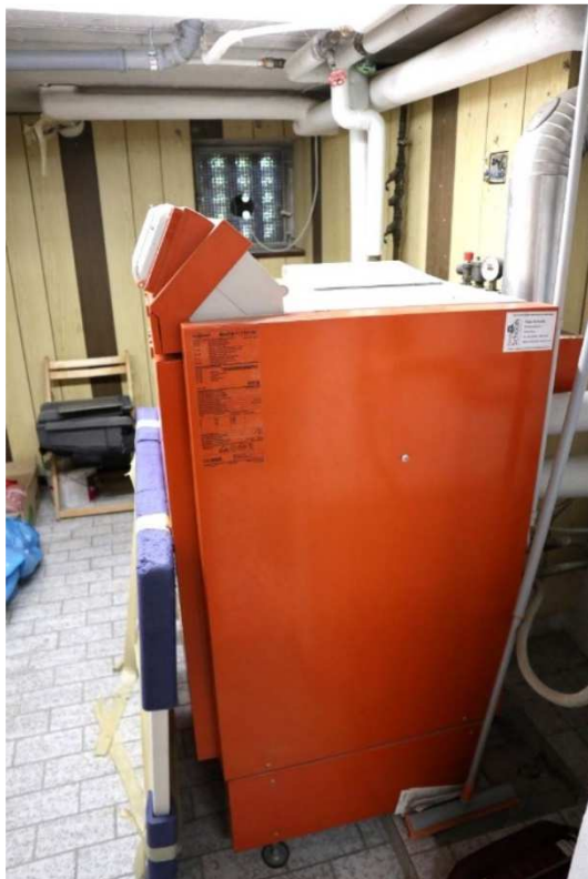
Foto 20: Gasheizung im Keller
