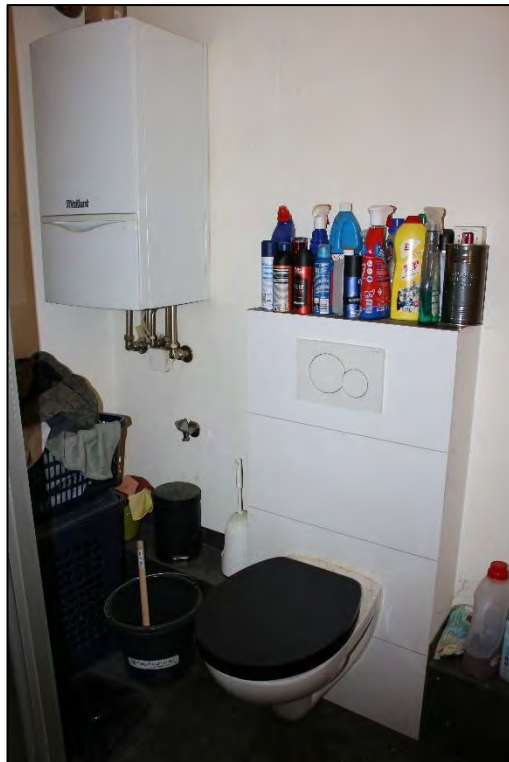
Foto Nr. 33: 2. OG, ETW Nr. 6, Bad / Heizung
