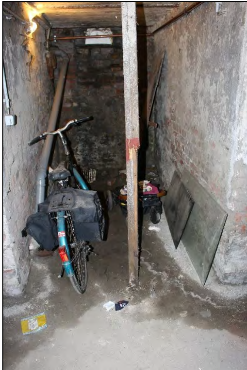
Foto Nr. 17: Kellergeschoss, Flur / Stromhausanschluss
