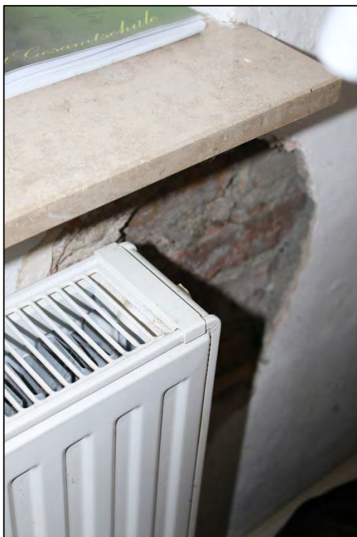
Foto Nr. 40: 2. OG, ETW Nr. 6, Schlafzimmer / Schaden Außenwand
