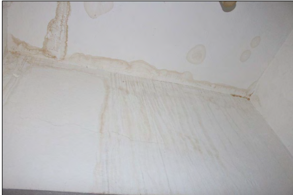
Foto Nr. 35: 2. OG, ETW Nr. 6, Flur / Feuchteschäden
