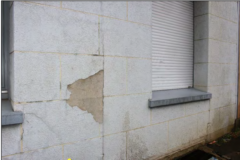
Foto Nr. 7: Straßenfassade, Schäden Putz
