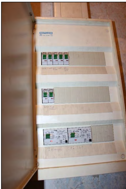
Foto Nr. 30: 2. OG, ETW Nr. 6, Abstellraum / Elektrounterverteilung
