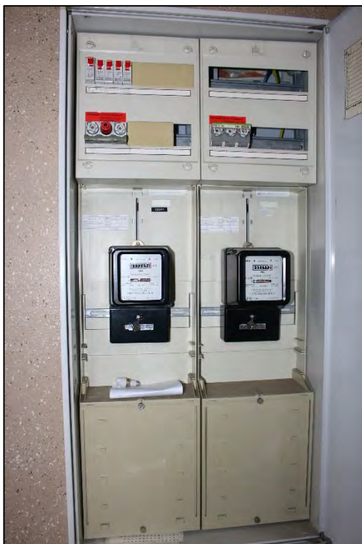
Foto Nr. 28: Gemeinschaftstreppehaus, 1. OG / Zählerschrank
