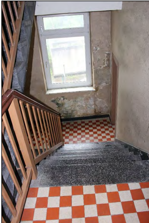
Foto Nr. 25: Gemeinschaftstreppehaus / Feuchteschäden
