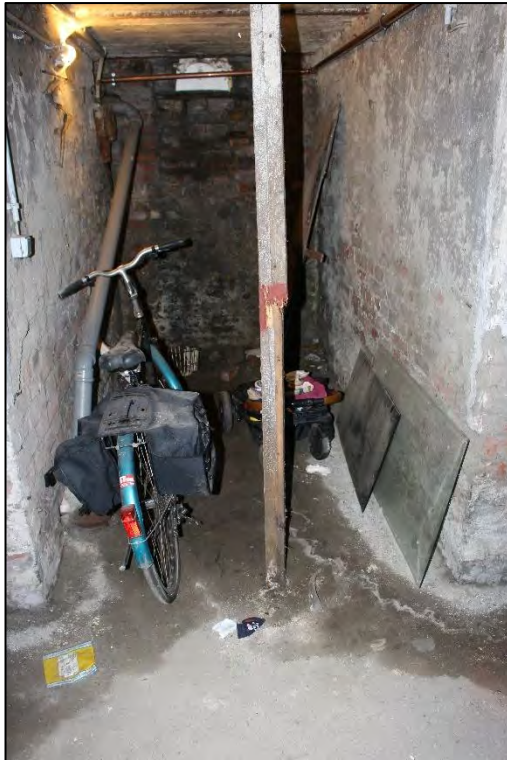
Foto Nr. 15: Kellergeschoss, Flur / Stromhausanschluss
