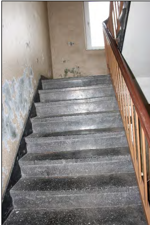
Foto Nr. 27: Gemeinschaftstreppehaus / Feuchteschäden
