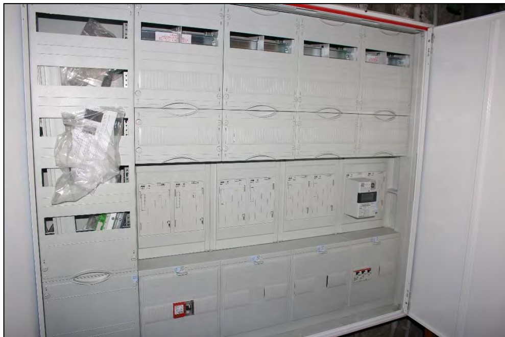
Foto Nr. 14: Kellergeschoss, Flur / Zählerschrank
