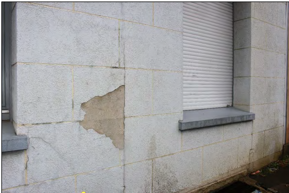
Foto Nr. 4: Straßenfassade, Schäden Putz
