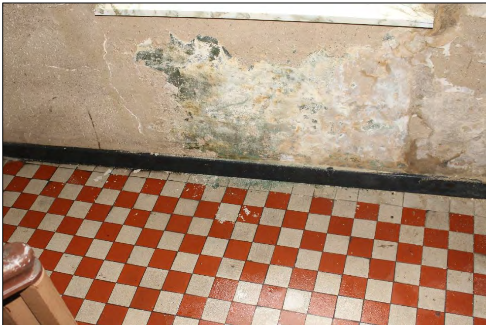
Foto Nr. 26: Gemeinschaftstreppehaus / Feuchteschäden
