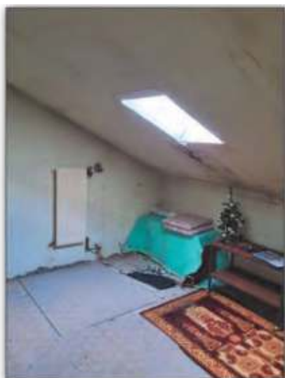
Foto 22 OG: Zimmer mit Wasseranschluss
