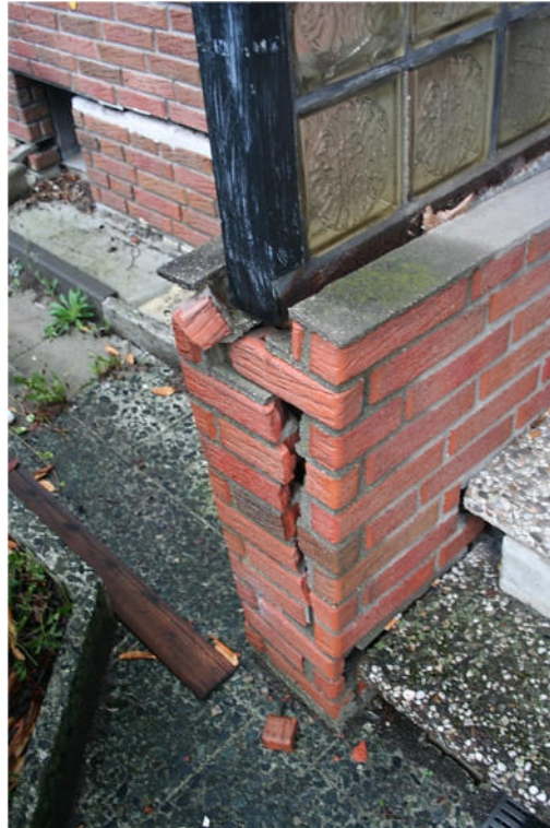
Bild 5: Detailfoto Schäden an der Eingangstreppe
