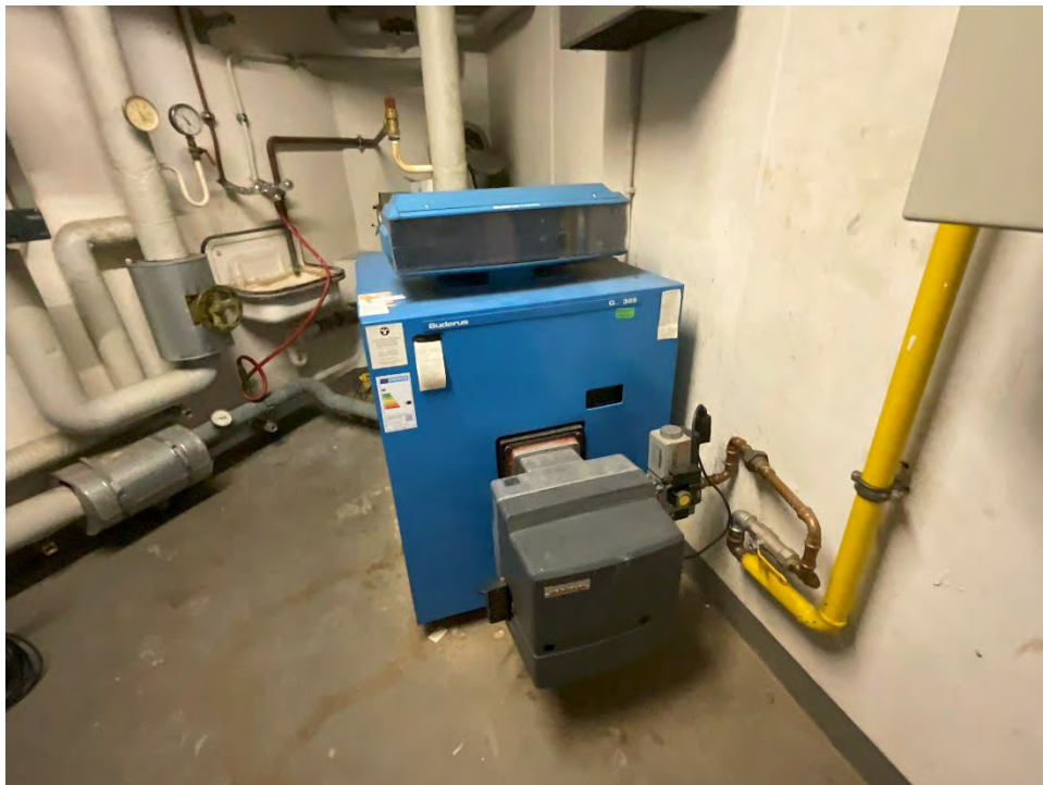
Lichtbild 19: Detail, Heizkessel zur Beheizung des Wohngebäudes „Rheinstraße 41“
