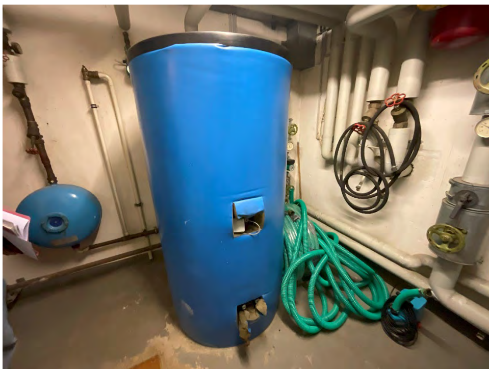
Lichtbild 20: Detail, Warmwasserstandspeicher des Wohngebäudes „Rheinstraße 41“
