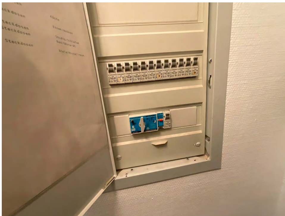
Lichtbild 9: Detail, Verteilerkasten (Elektro) mit Fehlerstromschutzschalter
