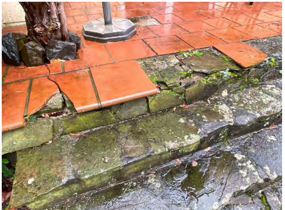
Lichtbild 32: Detail, Instandsetzungsrückstände im Bereich der Terrasse
