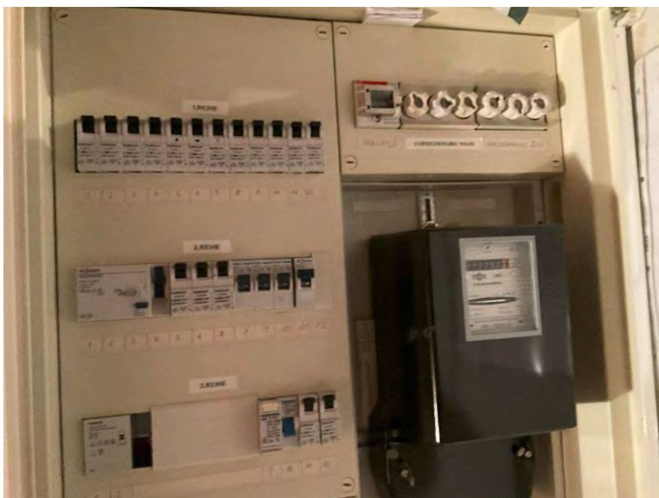
Lichtbild 14: Detail, Verteilerkasten (Elektro)
