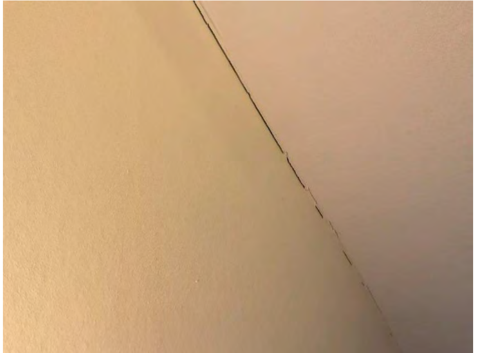
Lichtbild 31: Detail, Rissbildungen im Dachgeschoss
