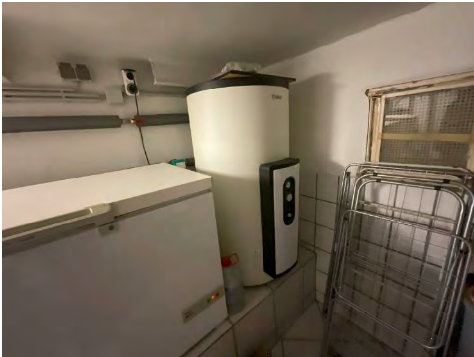
Lichtbild 13: Detail, Warmwasserspeicher im Sockelgeschoss
