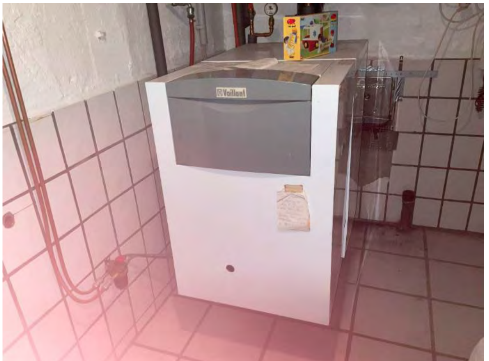
Lichtbild 12: Detail, Heizkessel im Sockelgeschoss
