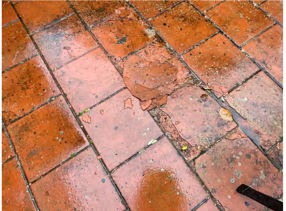
Lichtbild 33: Detail, Instandsetzungsrückstände im Bereich der Terrasse
