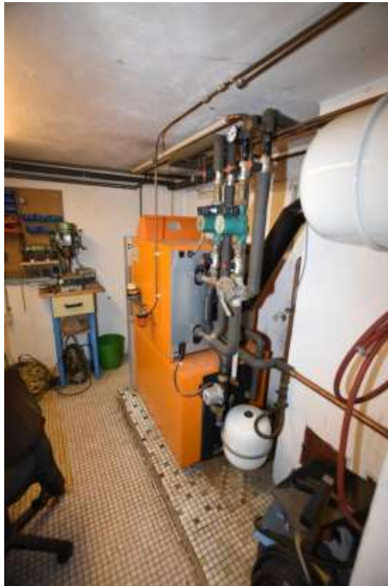
Ölzentralheizung zu Sondereigentum Nr. 3 (Öltanks in BT 1)
