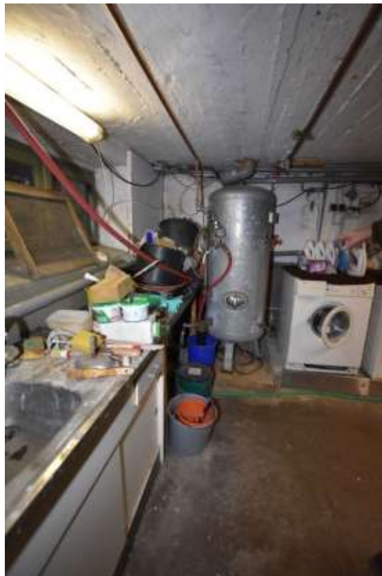
Hauswasserwerk in BT 1
