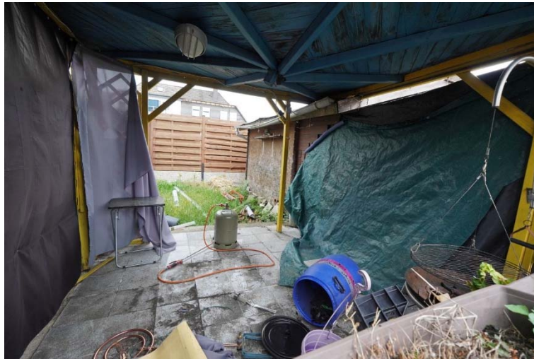
Überdachung in Eigenbau – abrisssreif
