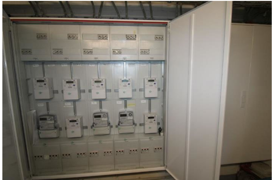
Sicht auf die Stromzähler im Hausanschlussraum / KG.
