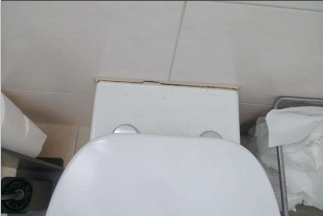
Abbildung 30 abgerissenes WC im Herren-WC im 1. Obergeschoss im Verwaltungsgebäude auf dem zu bewertenden Grundstück fotografiert am 07.03.2025
