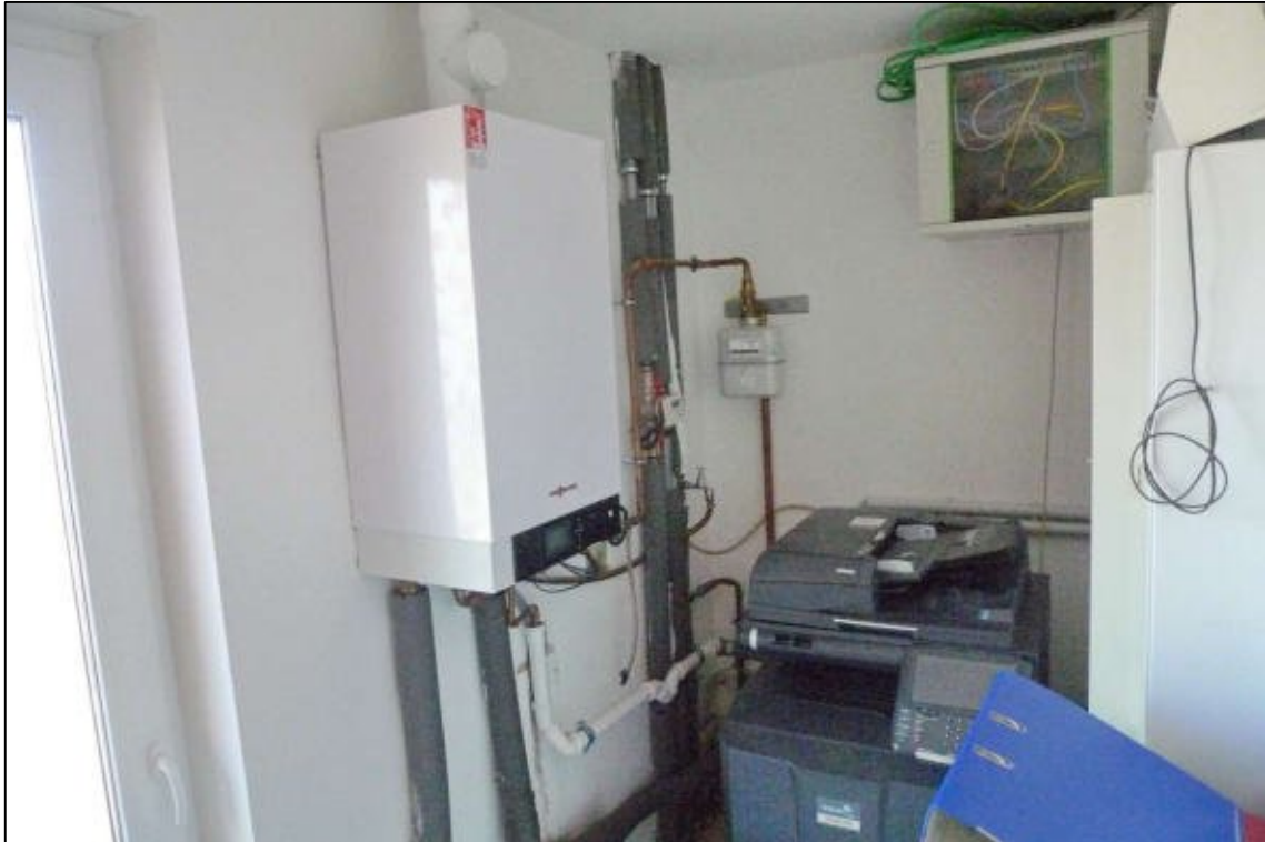
Abbildung 17 Heizungsanlage im Erdgeschoss vom Verwaltungsgebäude auf dem zu bewertenden Grundstück fotografiert am 07.03.2025
