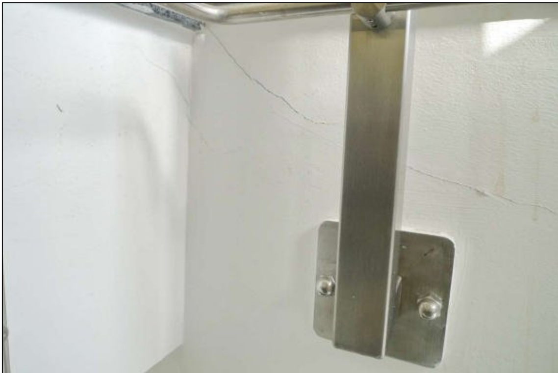
Abbildung 29 Rissbildung im Putz- und Mauerwerk im Treppenhaus am Verwaltungsgebäude auf dem zu bewertenden Grundstück fotografiert am 07.03.2025
