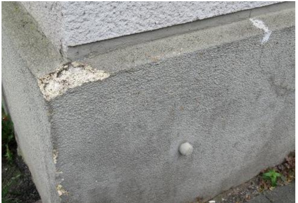
Putzabplatzungen und Risse
