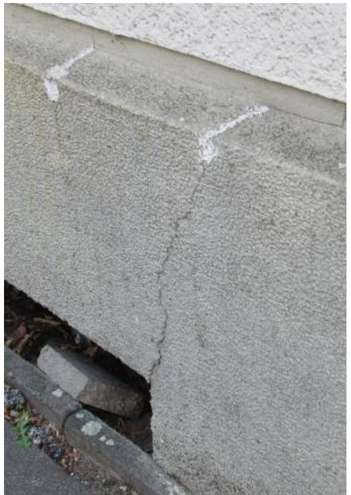
Risse in der Fassade
