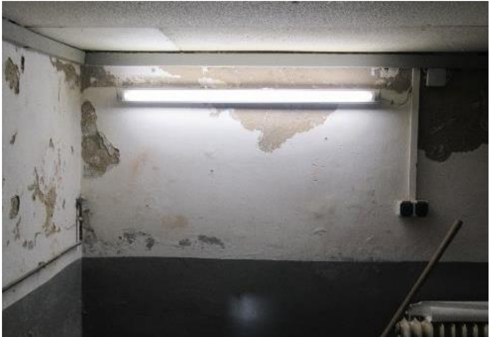
Durchfeuchtungen im Keller
