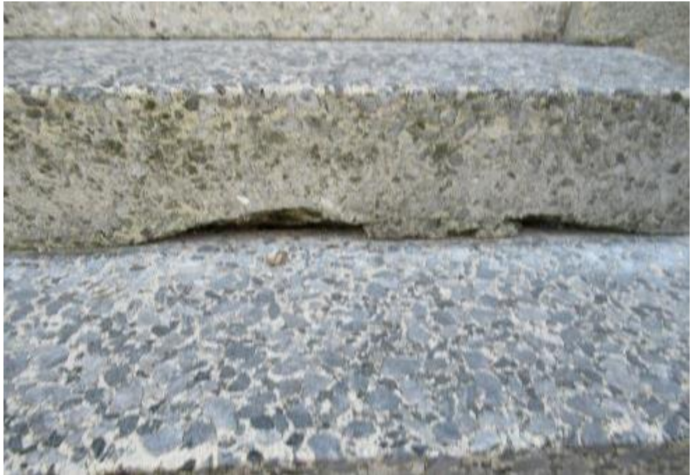
Schäden an der Eingangstreppe
