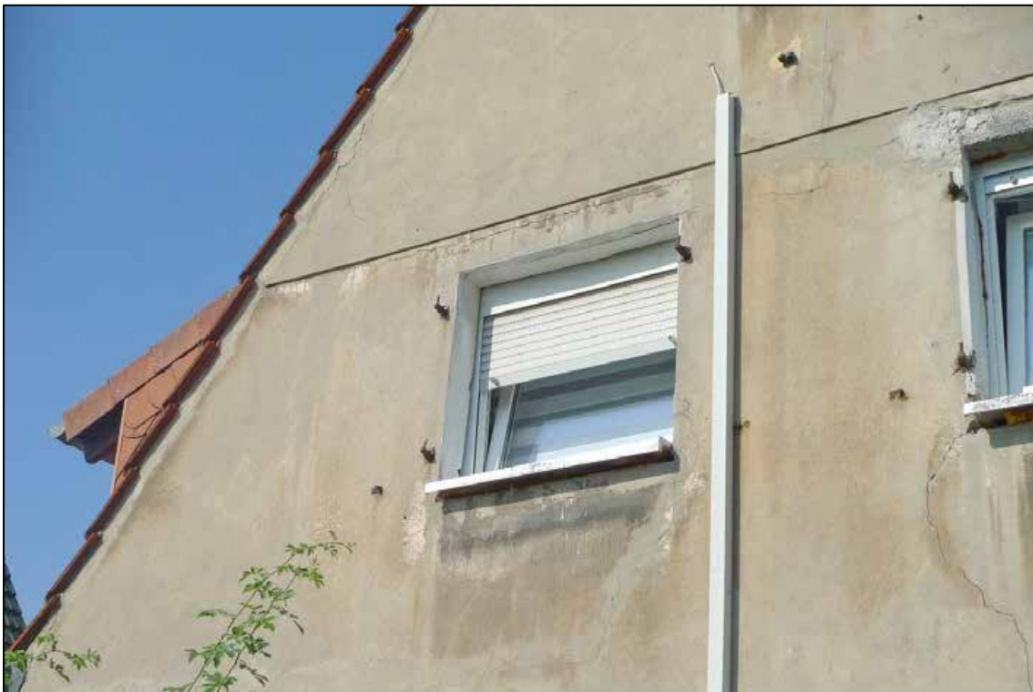
Abbildung 17 multiple Rissbildung an der Außenfassade (Straßenseite) der Einfamilien-Doppelhaushälfte auf dem zu bewertenden Grundstück fotografiert am 13.08.2024
