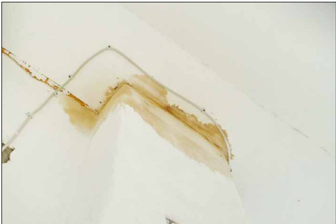
Abbildung 23 Versottung am Kamin der Einfamilien-Doppelhaushälfte auf dem zu bewertenden Grundstück fotografiert am 13.08.2024
