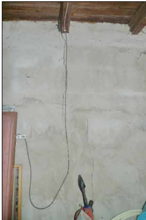
Abbildung 28 Rissbildung in der Außenwand der Garage auf dem zu bewertenden Grundstück fotografiert am 13.08.2024
