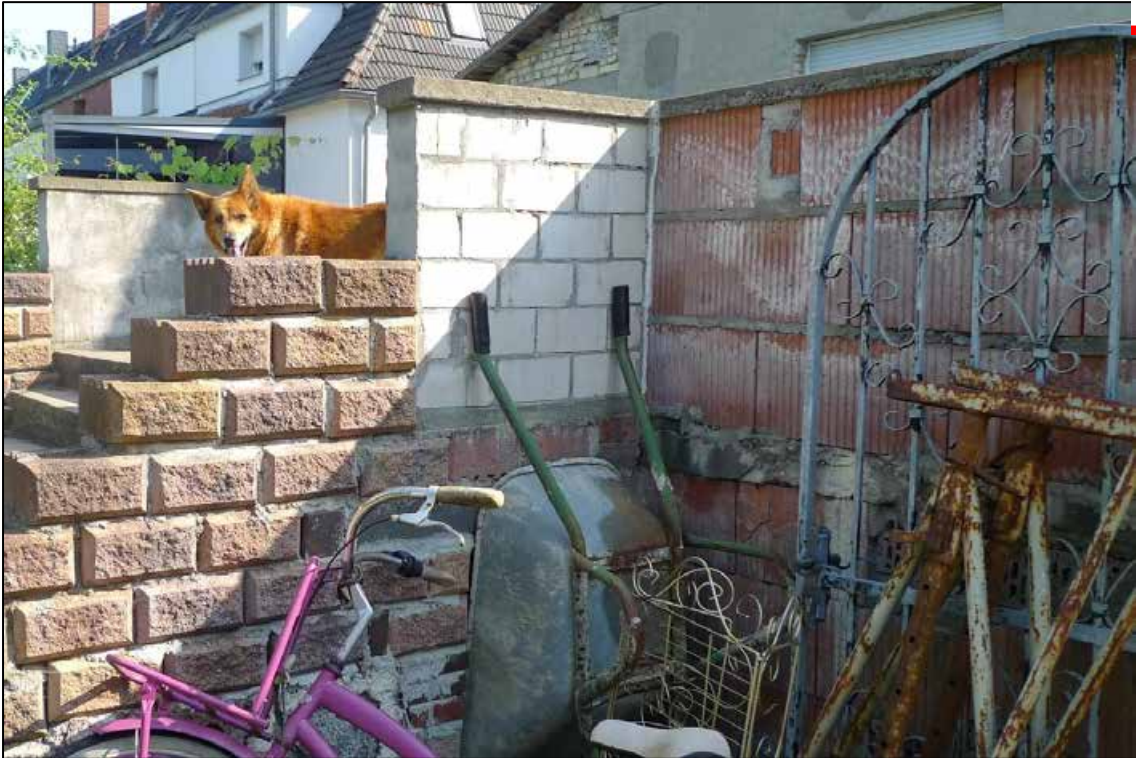
Abbildung 20 nicht abgeschlossene Putzarbeiten an der Terrasse der Einfamilien-Doppelhaushälfte auf dem zu bewertenden Grundstück fotografiert am 13.08.2024
