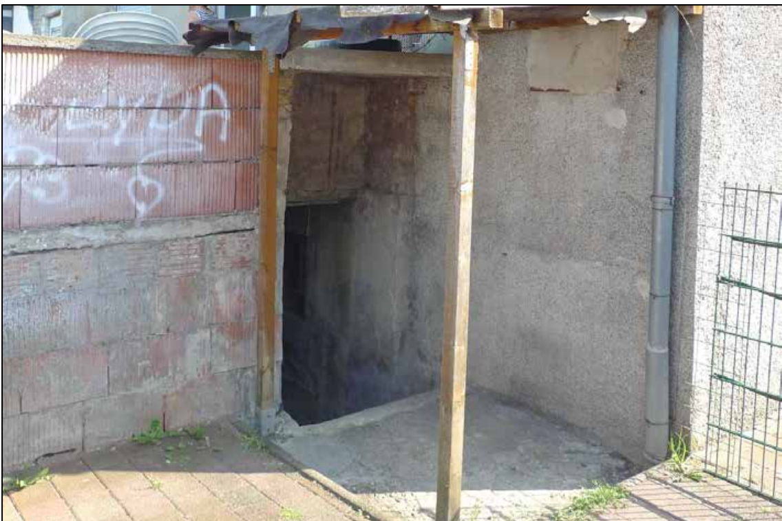
Abbildung 21 nicht abgeschlossene Putzarbeiten an der Terrasse und Kellerabgang der Einfamilien-Doppelhaushälfte auf dem zu bewertenden Grundstück fotografiert am 13.08.2024
