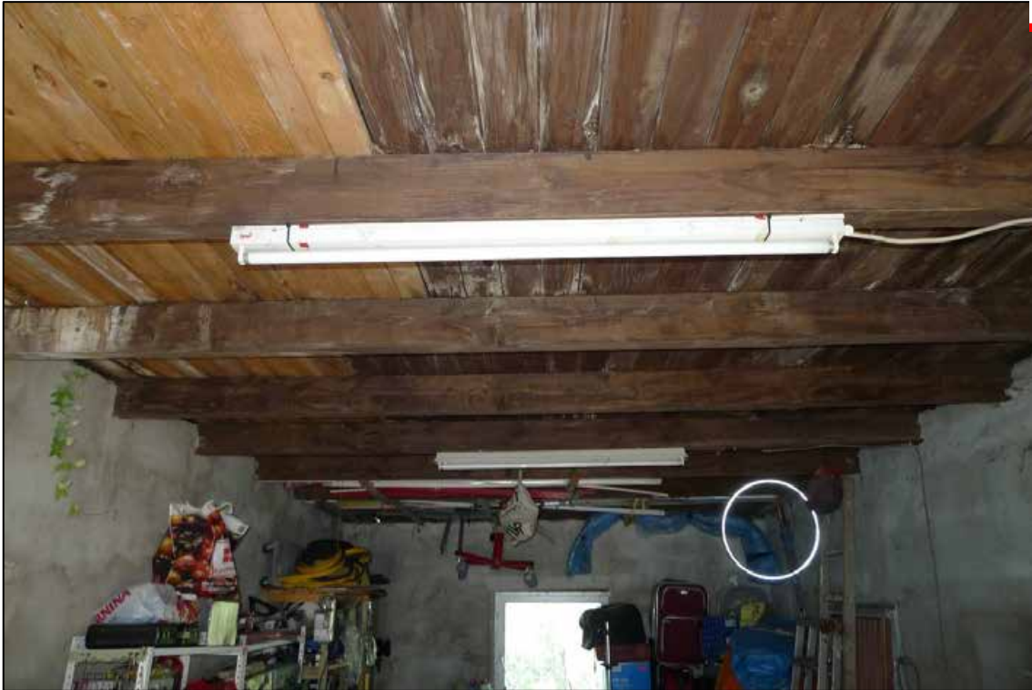
Abbildung 29 Feuchtigkeitsflecken in der Decke der Garage auf dem zu bewertenden Grundstück fotografiert am 13.08.2024
