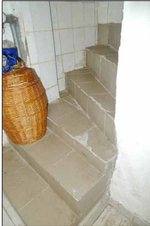
Abbildung 22 defekter Fliesenoberbelag auf der Kellertreppe der Einfamilien-Doppelhaushälfte auf dem zu bewertenden Grundstück fotografiert am 13.08.2024
