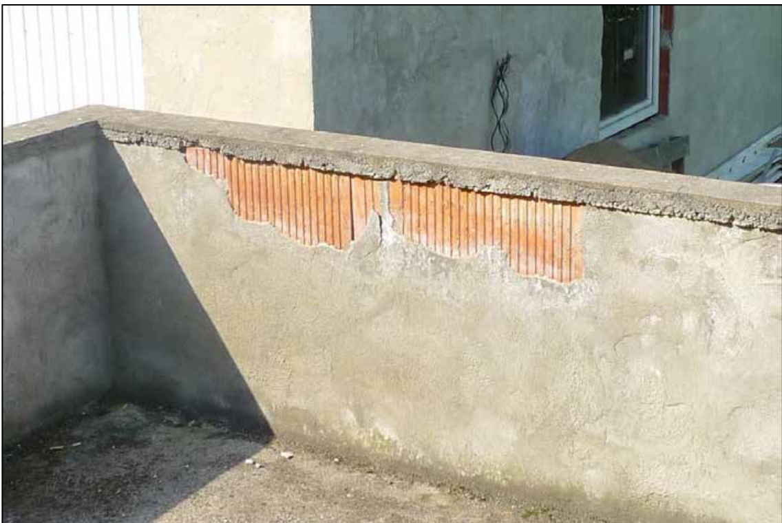
Abbildung 19 Putzabplatzungen an der Terrasse der Einfamilien-Doppelhaushälfte auf dem zu bewertenden Grundstück fotografiert am 13.08.2024
