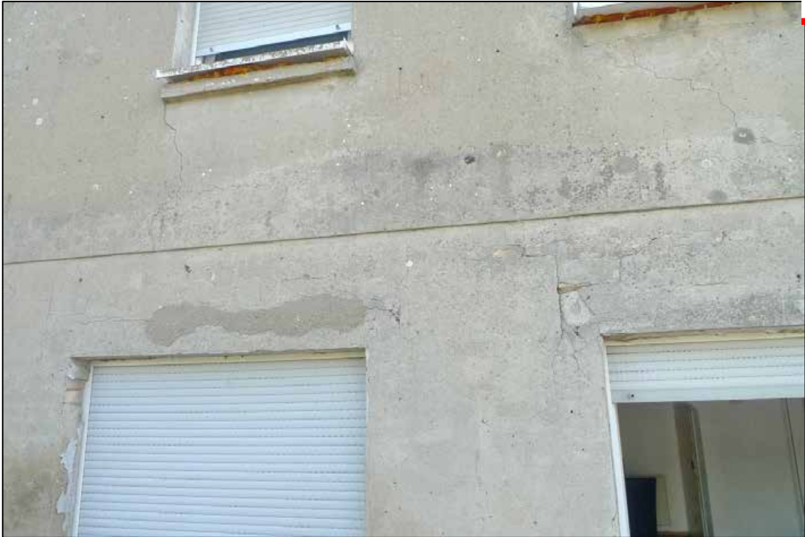
Abbildung 18 multiple Rissbildung an der Außenfassade (Rückseite) der Einfamilien-Doppelhaushälfte auf dem zu bewertenden Grundstück fotografiert am 13.08.2024
