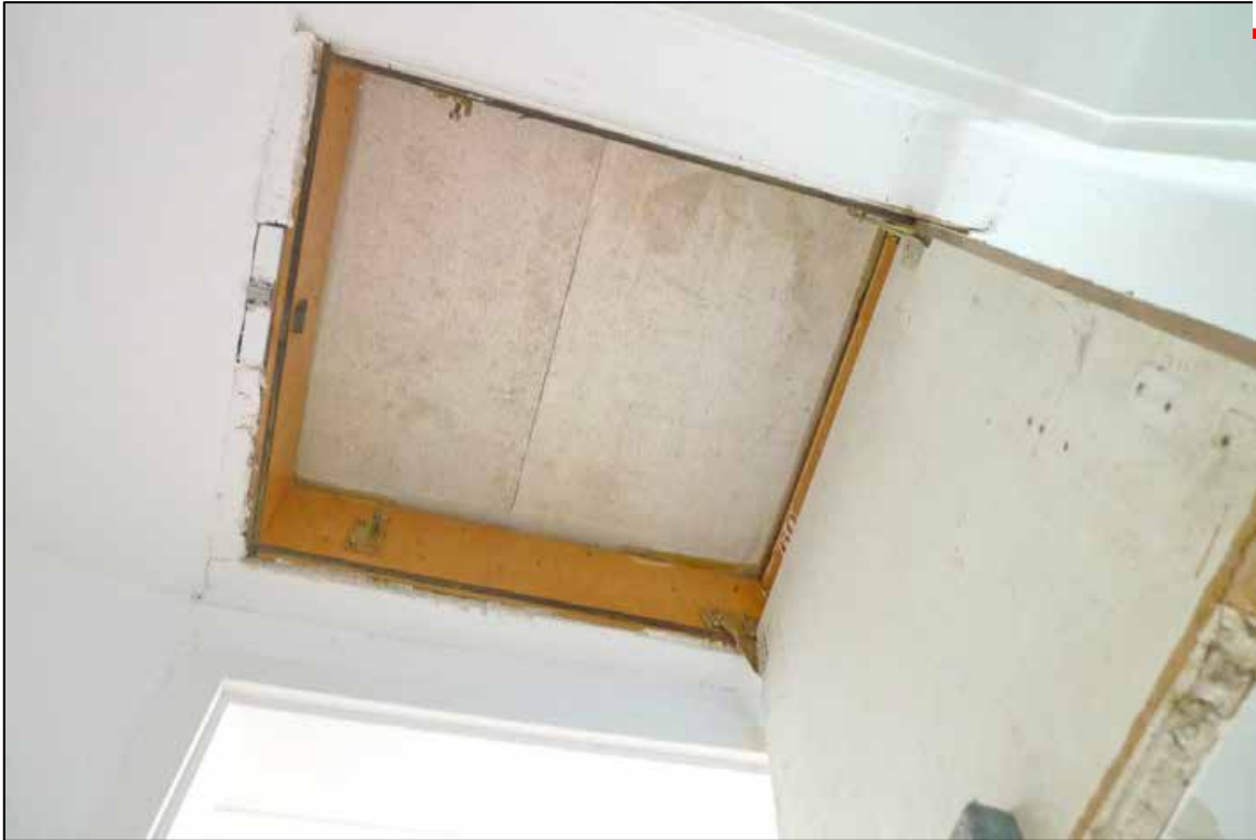
Abbildung 24 fehlende Leiter zum Spitzboden der Einfamilien-Doppelhaushälfte auf dem zu bewertenden Grundstück fotografiert am 13.08.2024
