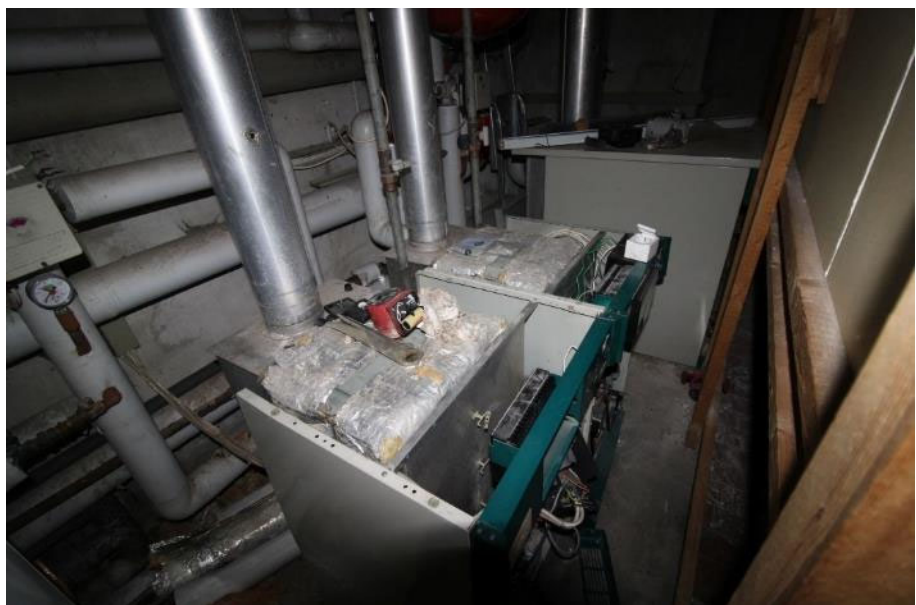
Sicht auf die Heizkes- sel / KG
