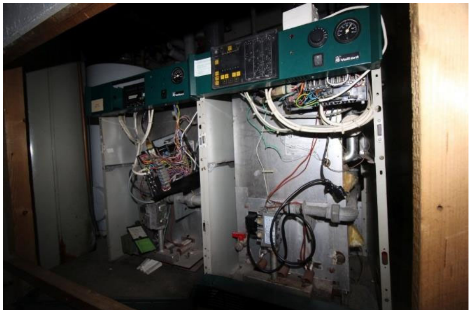
Sicht auf die Heizkes- sel / KG
