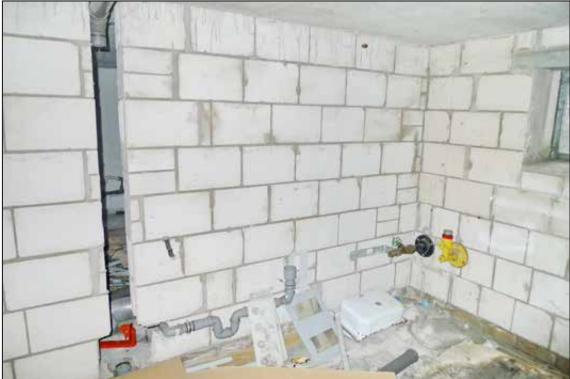
Abbildung 16 Hausanschlüsse im Kellergeschoss fotografiert am 24.01.2025
