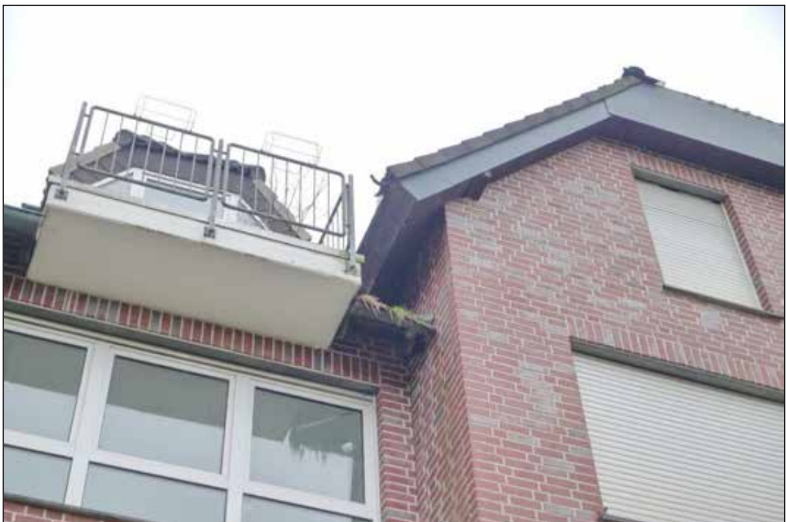
Abbildung 31 demontierte Regenfallrohre fotografiert am 24.01.2025
