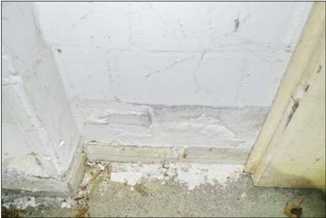
Abbildung 40 Feuchtigkeits im gesamten Kellergeschoss fotografiert am 24.01.2025
