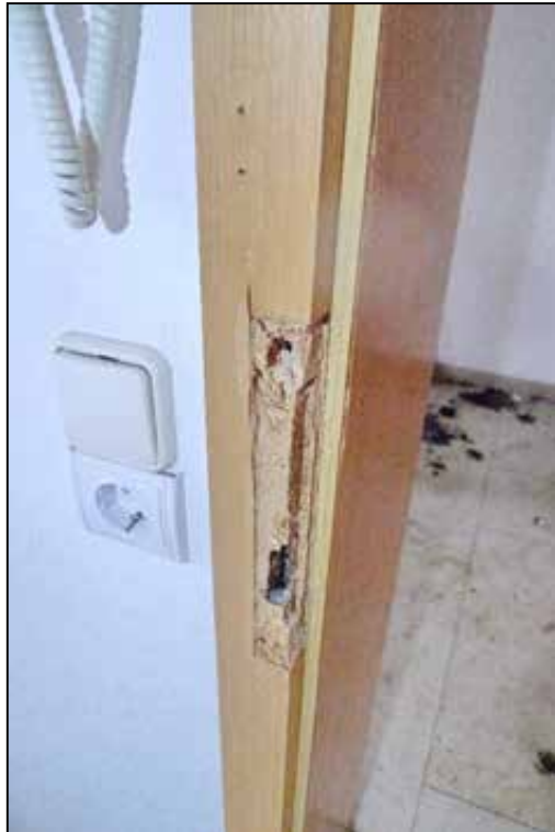
Abbildung 65 aufgebrochene Wohnungseingangstür fotografiert am 24.01.2025
