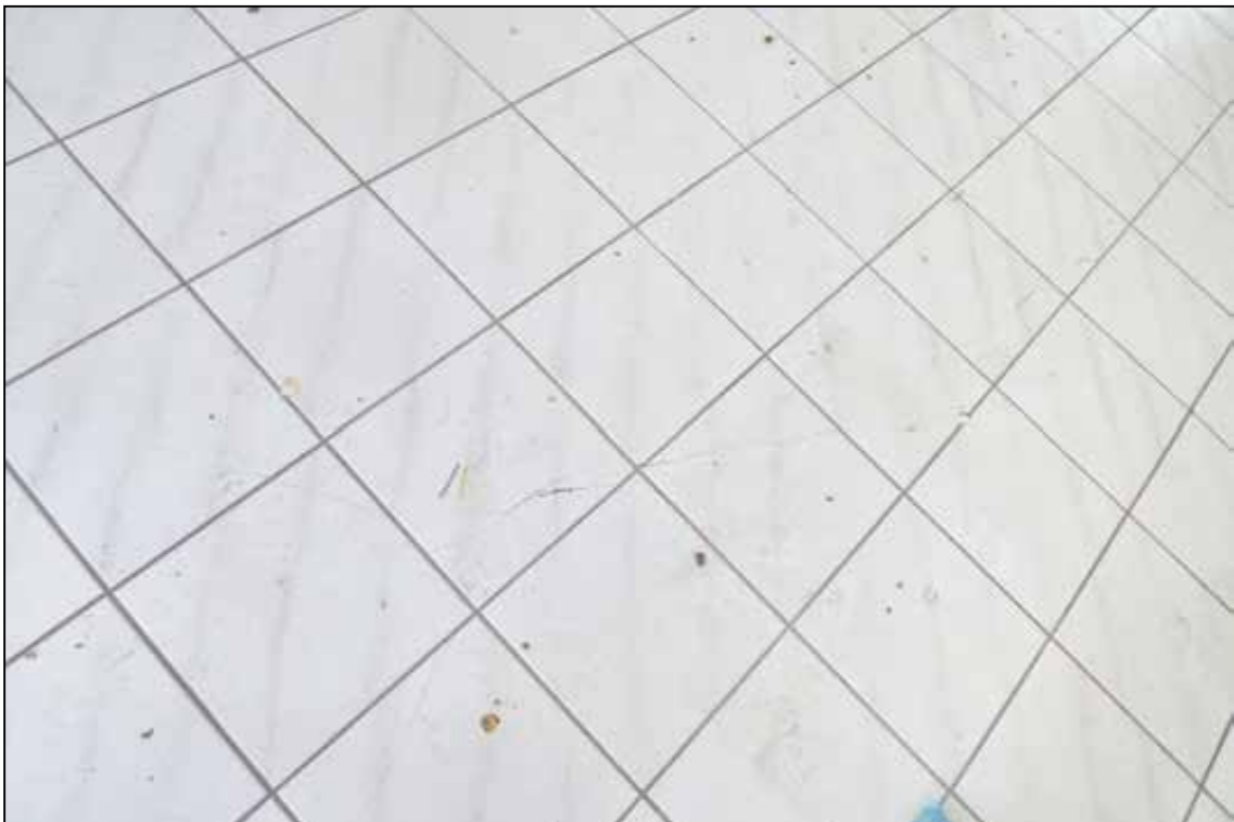
Abbildung 69 Rissbildungen am Fußbodenoberbelag fotografiert am 24.01.2025
