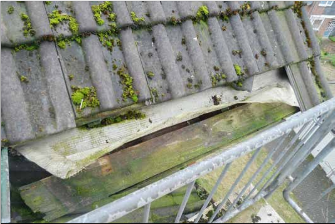
Abbildung 42 fehlende Dachsteine fotografiert am 24.01.2025
