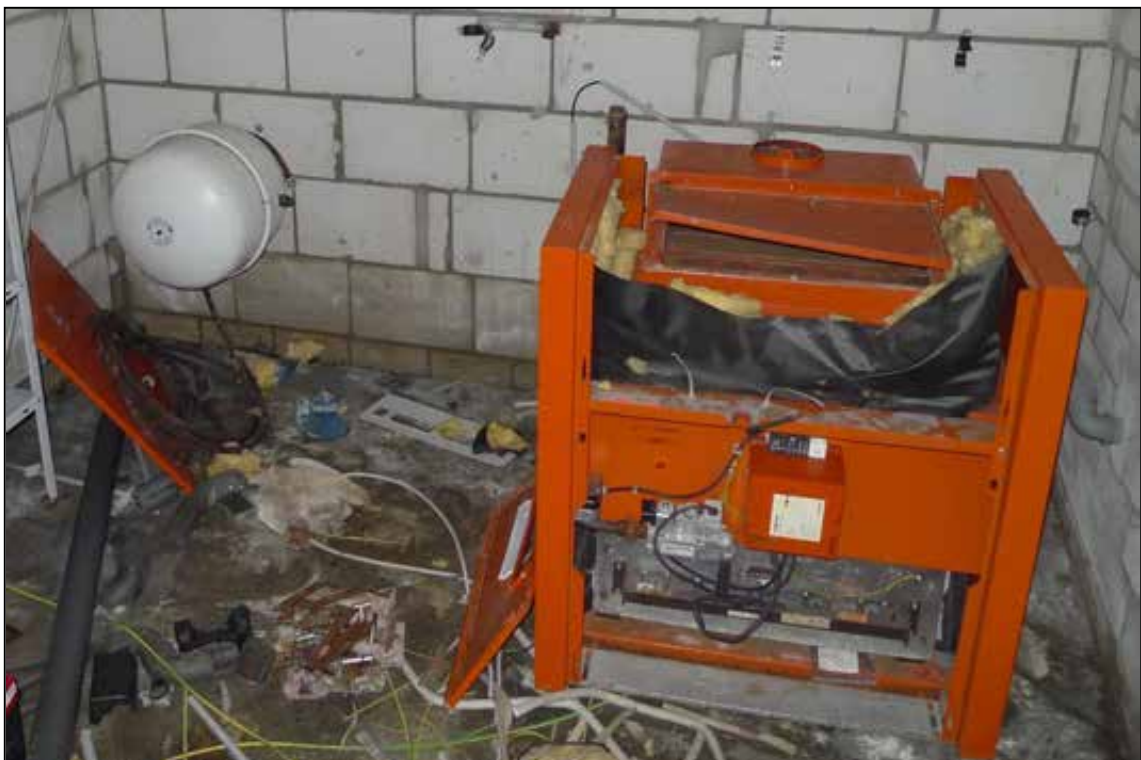
Abbildung 37 demontierte, zerstörte Heizungsanlage fotografiert am 24.01.2025
