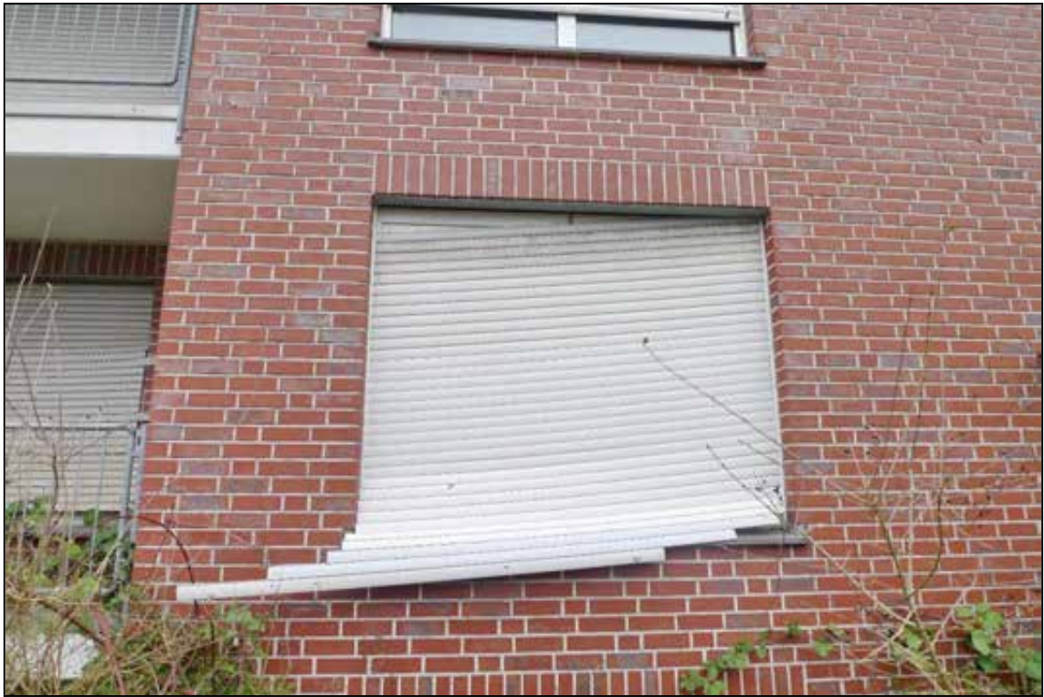
Abbildung 30 defekte Rollläden an mehreren Fenstern fotografiert am 24.01.2025
