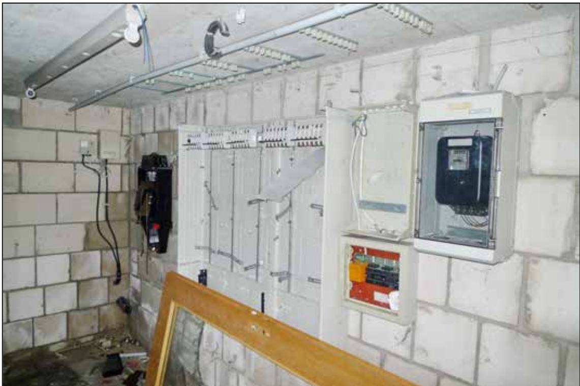
Abbildung 17 demontierte Sicherungskästen im Kellergeschoss fotografiert am 24.01.2025
