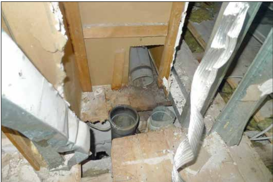
Abbildung 41 demontierte Leitungen auf dem Spitzboden fotografiert am 24.01.2025
