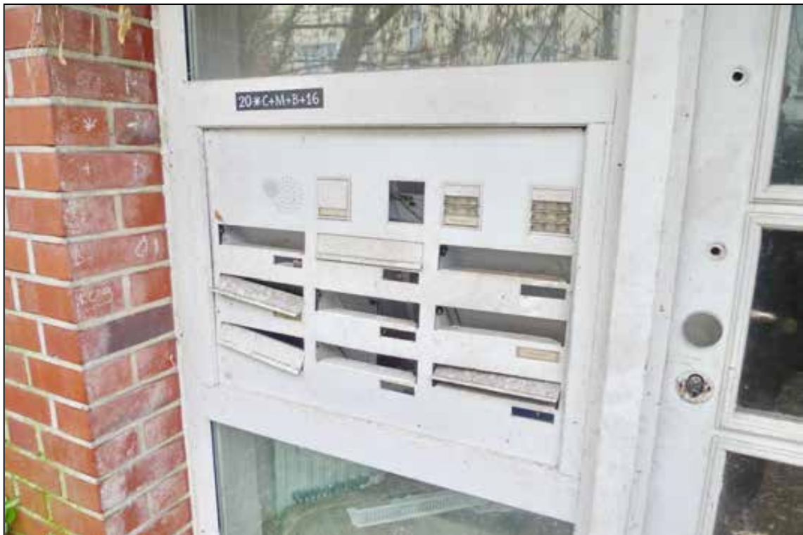
Abbildung 27 demolierte und defekte Briefkastenanlage fotografiert am 24.01.2025
