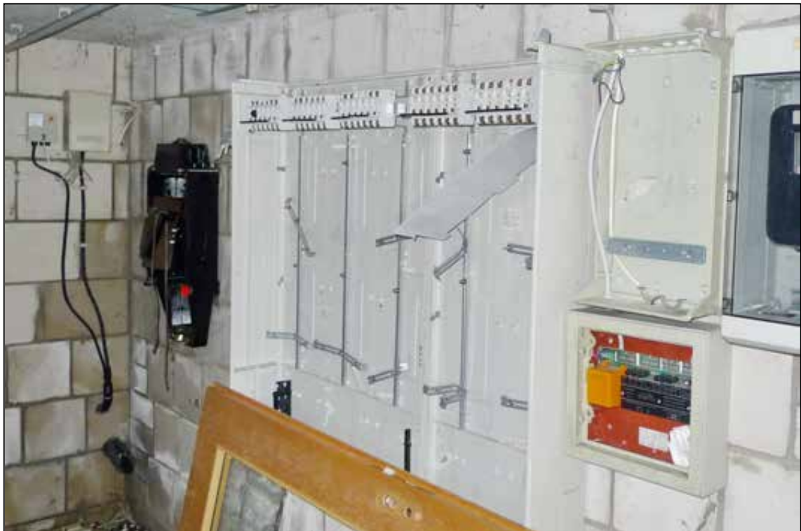
Abbildung 39 demontierte Sicherungskästen und Stromverteilungen fotografiert am 24.01.2025
