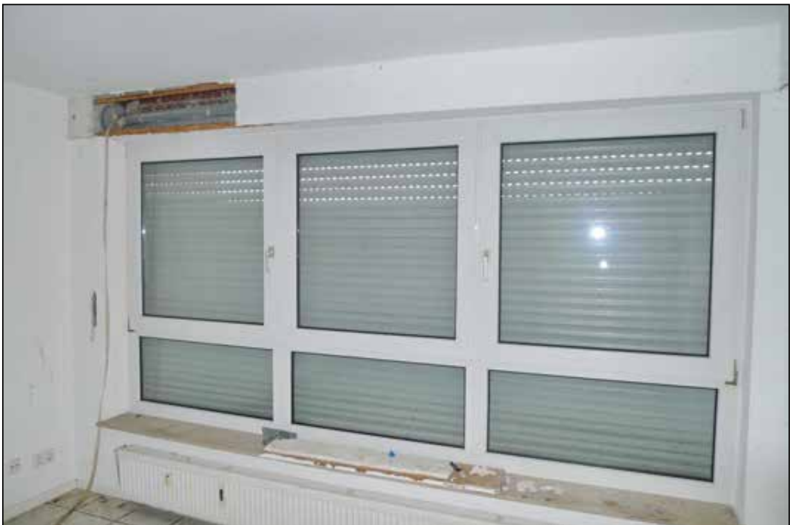
Abbildung 69 defekte Rollladen und aufgebrochener Rolllädenkasten fotografiert am 24.01.2025
