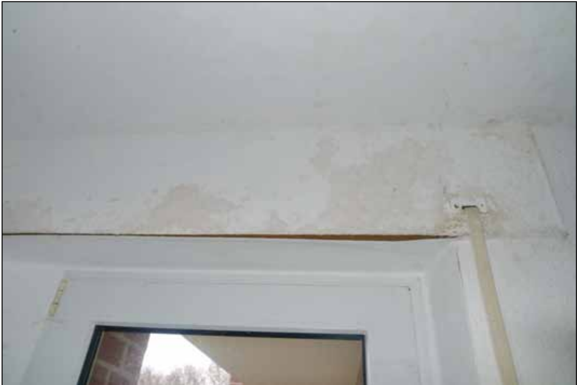
Abbildung 68 Feuchtigkeit am Rollladenkasten zum Balkon fotografiert am 24.01.2025
