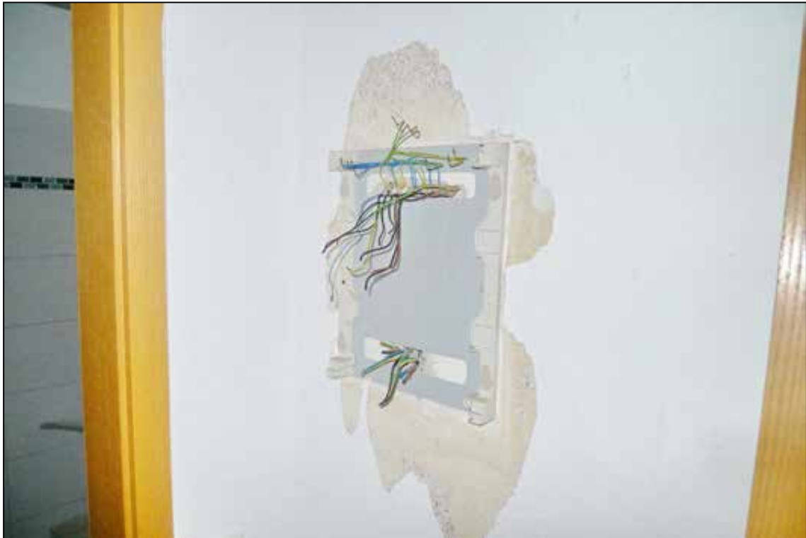
Abbildung 65 demontierter Sicherungskasten fotografiert am 24.01.2025
