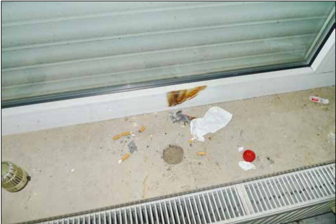
Abbildung 66 Brandflecken am Fenster im Schlafraum fotografiert am 24.01.2025
