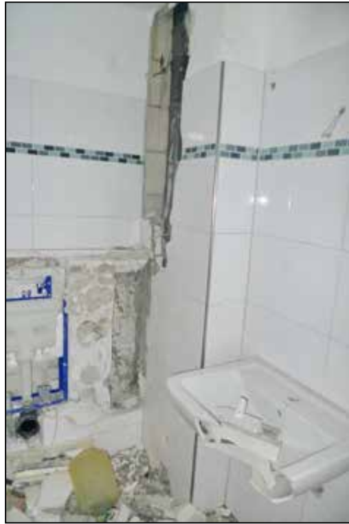
Abbildung 67 zerstörtes Bad fotografiert am 24.01.2025
