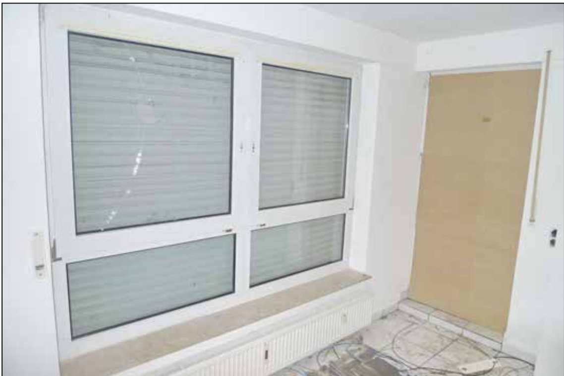
Abbildung 70 zerstörtes Fenster und zerstörte Balkontür fotografiert am 24.01.2025
