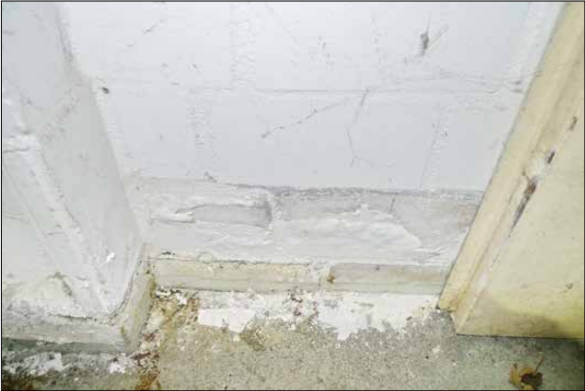
Abbildung 40 Feuchtigkeits im gesamten Kellergeschoss fotografiert am 24.01.2025
