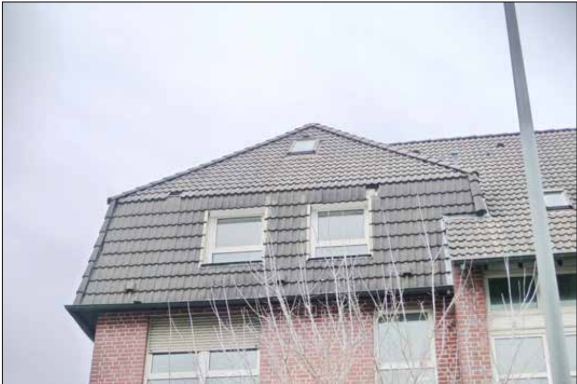
Abbildung 32 undichtetes Dach aufgrund von fehlenden Betondachsteinen fotografiert am 24.01.2025
