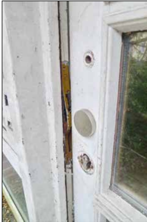
Abbildung 26 Aufgebrochene Hauseingangstür fotografiert am 24.01.2025
