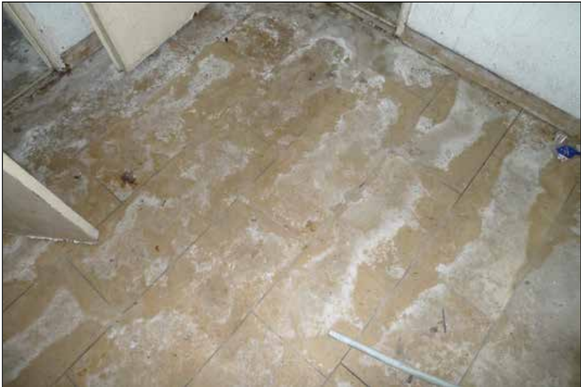
Abbildung 34 Ausblühungen auf dem Fußbodenoberbelag im Kellergeschoss fotografiert am 24.01.2025
