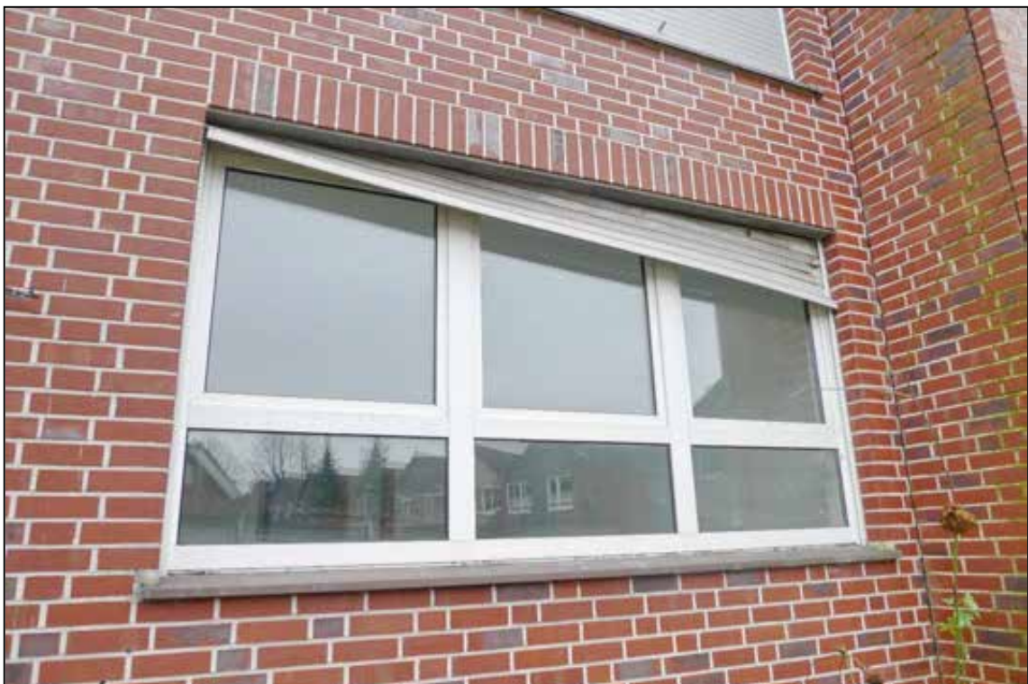
Abbildung 29 defekte Rollläden an mehreren Fenstern fotografiert am 24.01.2025
