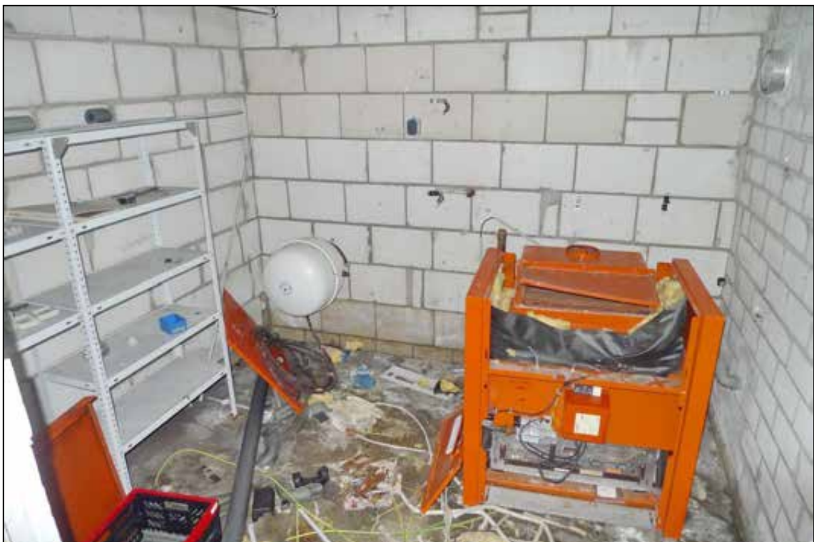
Abbildung 15 Heizungsraum mit demontierter Heizungsanlage im Kellergeschoss fotografiert am 24.01.2025
