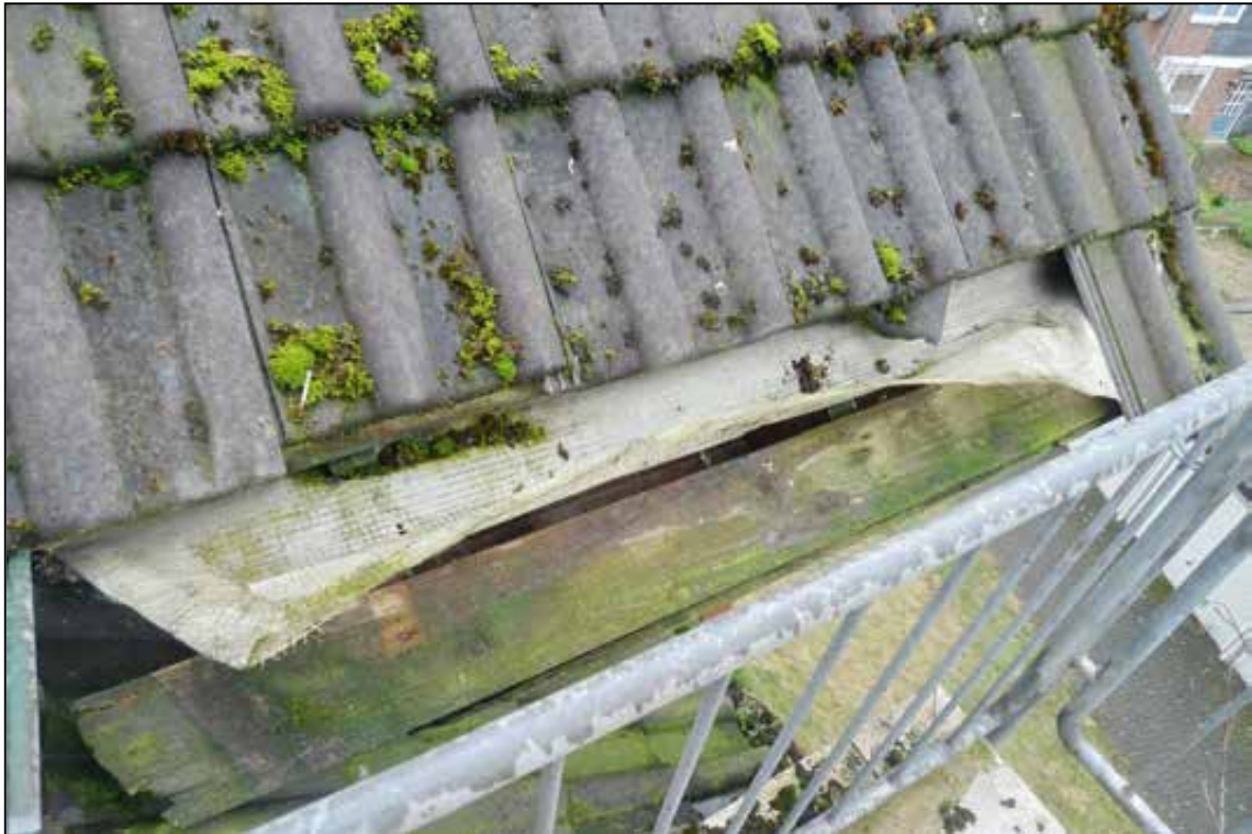
Abbildung 42 fehlende Dachsteine fotografiert am 24.01.2025
