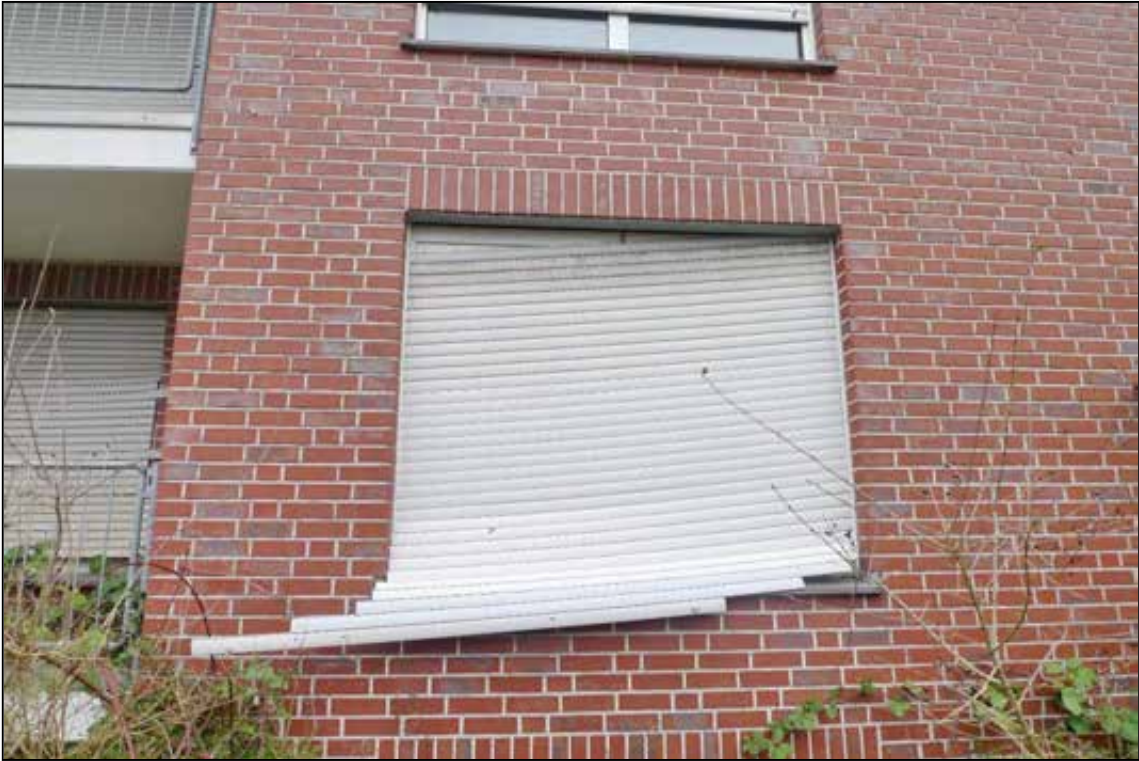
Abbildung 30 defekte Rollläden an mehreren Fenstern fotografiert am 24.01.2025
