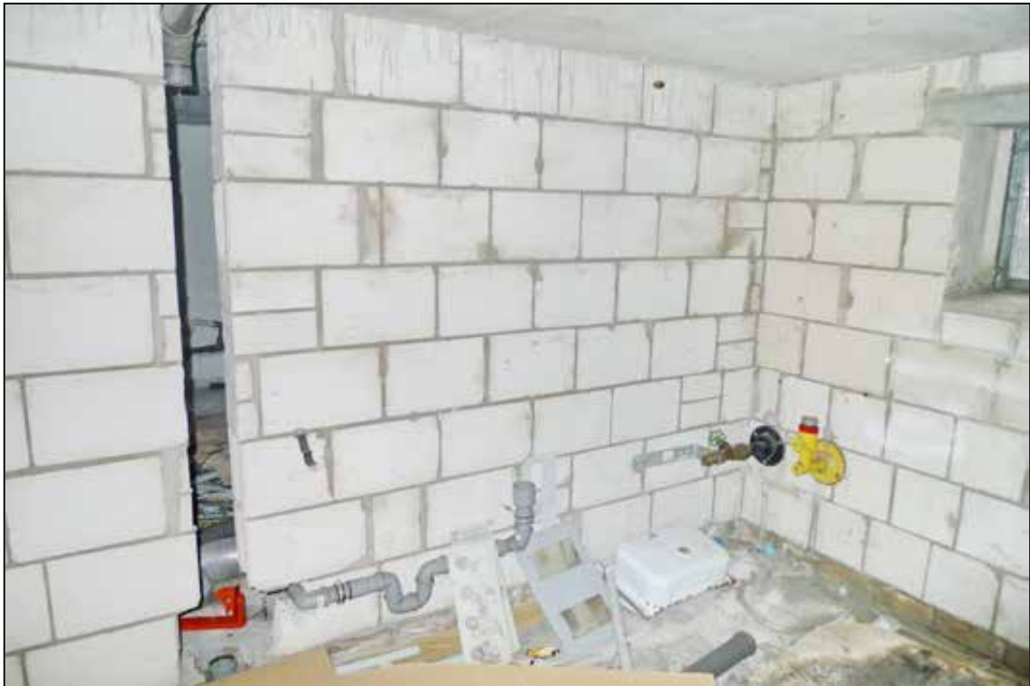
Abbildung 16 Hausanschlüsse im Kellergeschoss fotografiert am 24.01.2025
