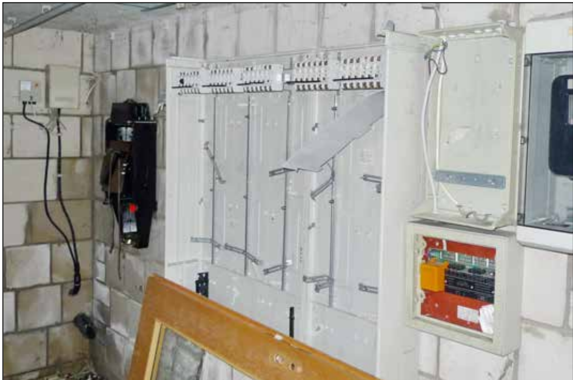
Abbildung 39 demontierte Sicherungskästen und Stromverteilungen fotografiert am 24.01.2025
