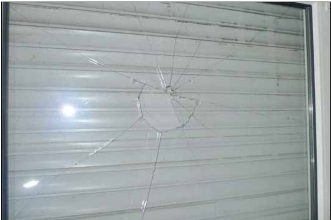
Abbildung 68 zerstörtes Fensterglas fotografiert am 24.01.2025
