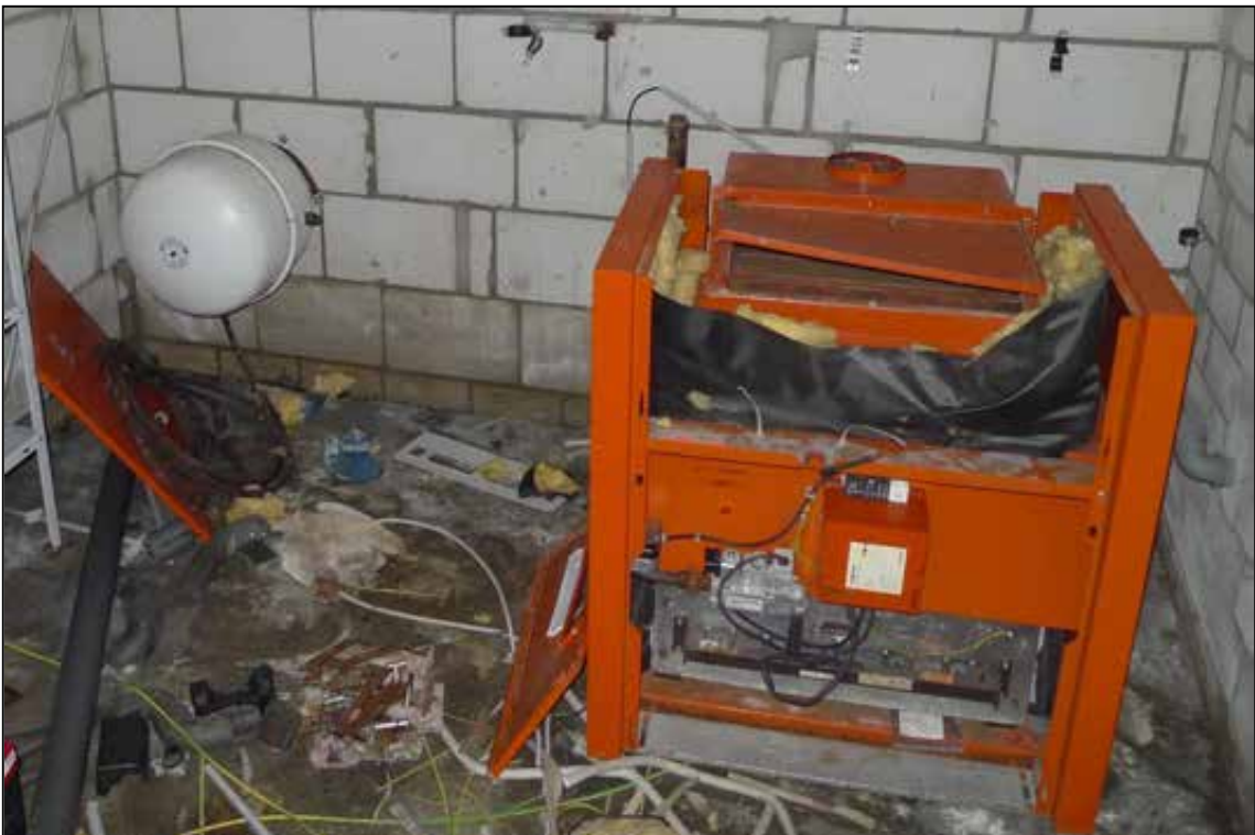
Abbildung 37 demontierte, zerstörte Heizungsanlage fotografiert am 24.01.2025
