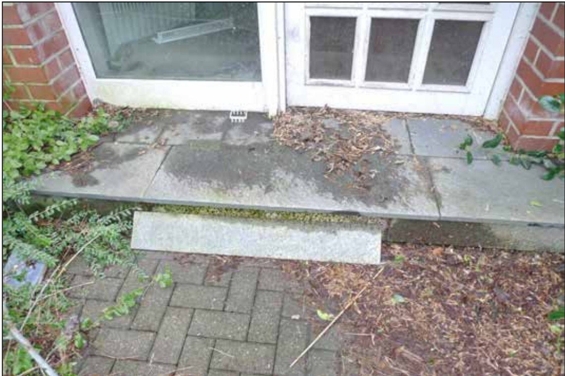
Abbildung 28 Beschädigungen des Oberbodenbelags der Differenzausgleichsstufe fotografiert am 24.01.2025
