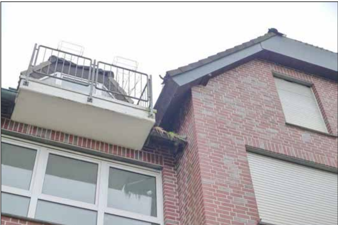
Abbildung 31 demontierte Regenfallrohre fotografiert am 24.01.2025
