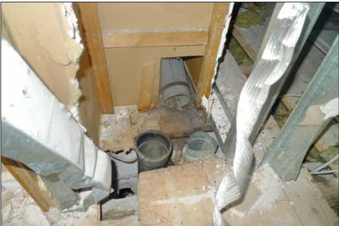
Abbildung 41 demontierte Leitungen auf dem Spitzboden fotografiert am 24.01.2025
