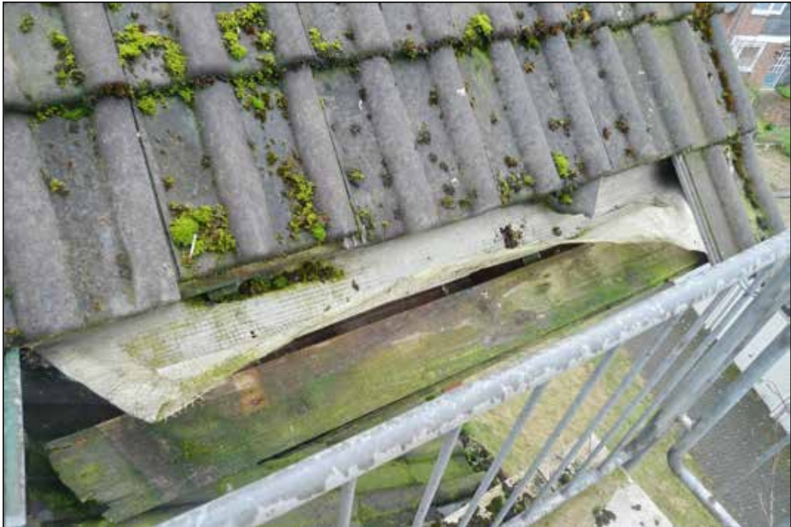
Abbildung 42 fehlende Dachsteine fotografiert am 24.01.2025
