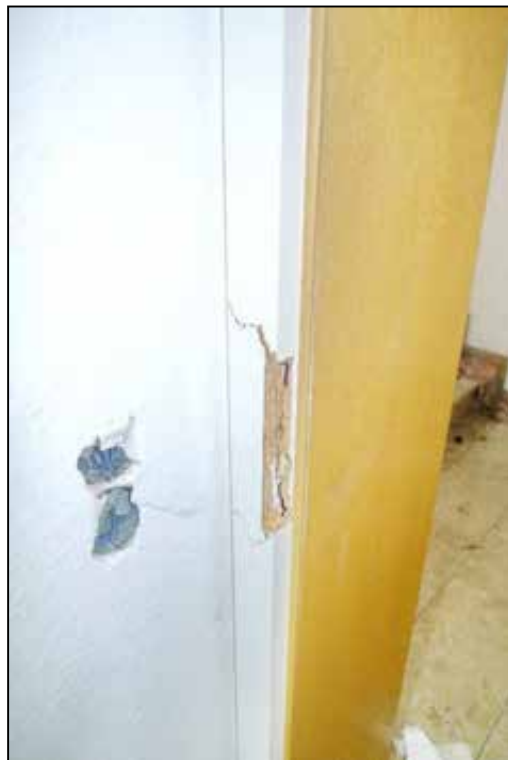
Abbildung 69 aufgebrochene Wohnungseingangstür fotografiert am 24.01.2025
