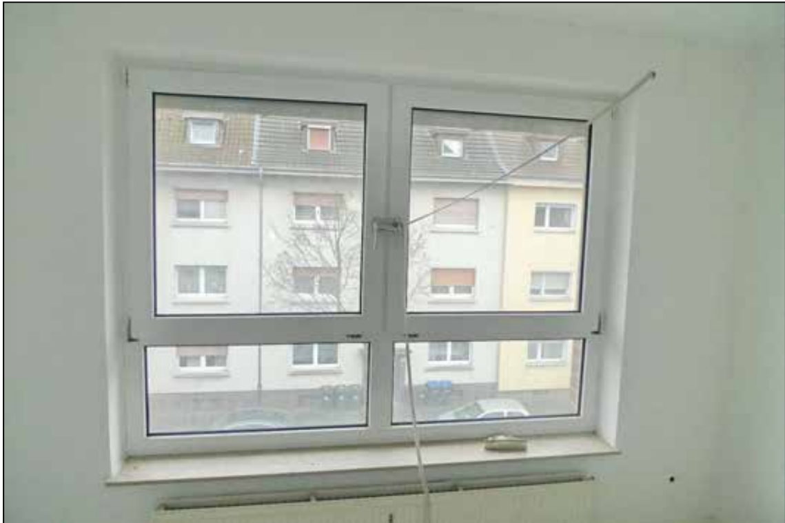
Abbildung 66 defekte Rollläden fotografiert am 24.01.2025
