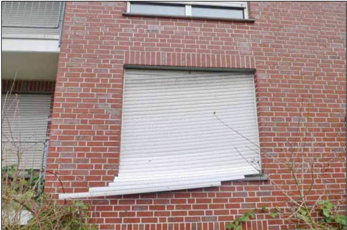
Abbildung 30 defekte Rollläden an mehreren Fenstern fotografiert am 24.01.2025
