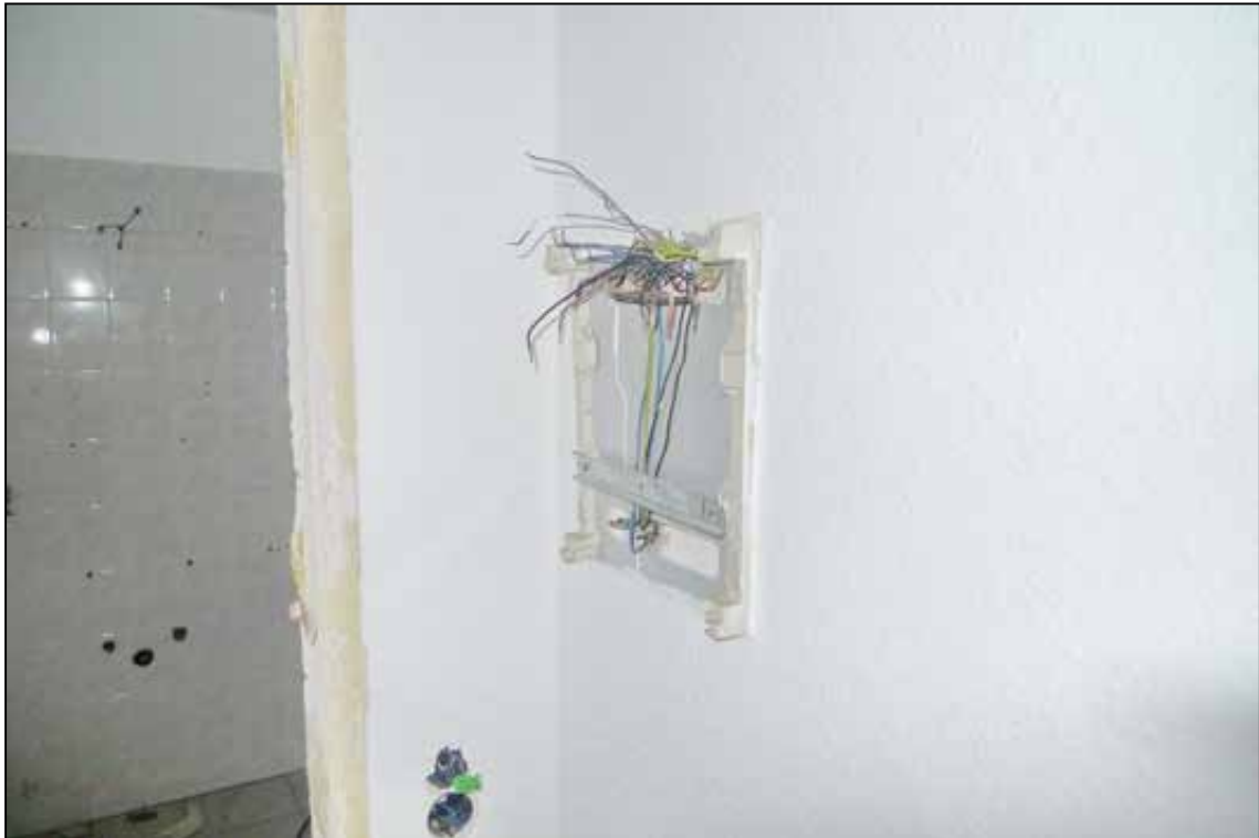
Abbildung 65 demontierter Sicherungskasten fotografiert am 24.01.2025
