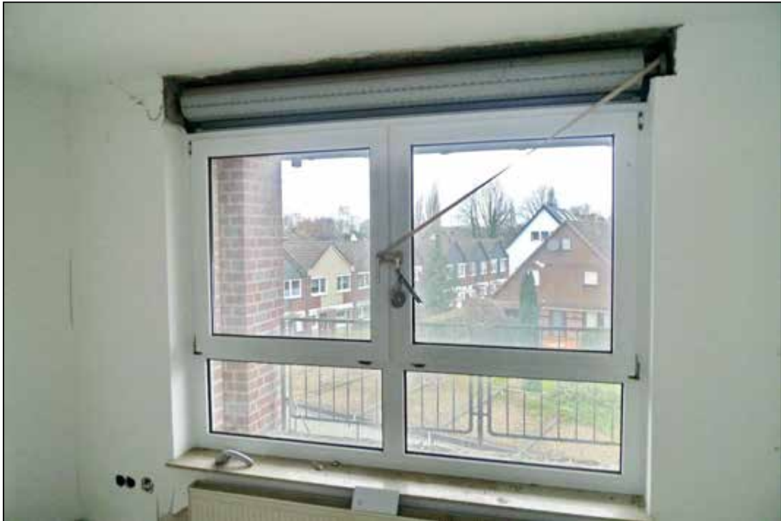
Abbildung 68 defekte Rollläden und aufgebrochener Rolllädenkasten fotografiert am 24.01.2025
