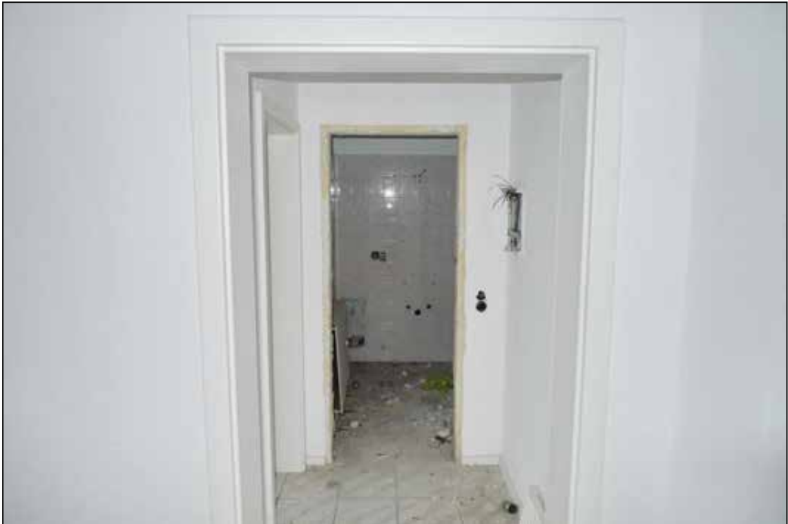
Abbildung 61 Vorflur des Wertermittlungsobjektes fotografiert am 24.01.2025
