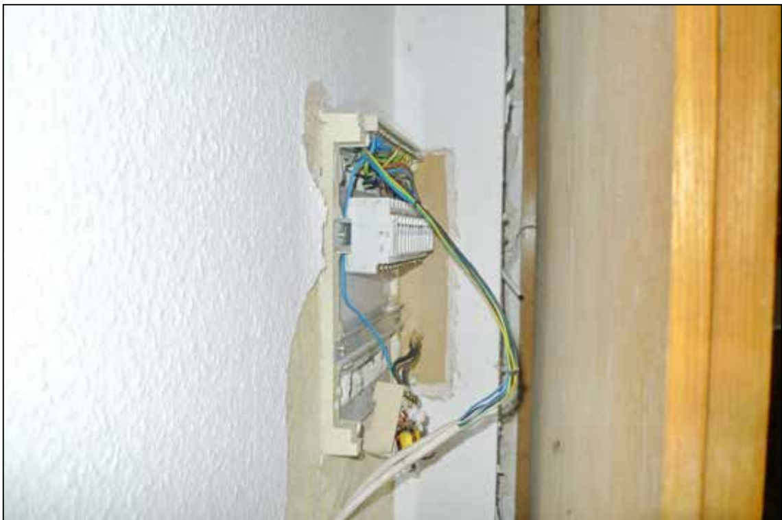
Abbildung 67 demontierter Sicherungskasten fotografiert am 24.01.2025
