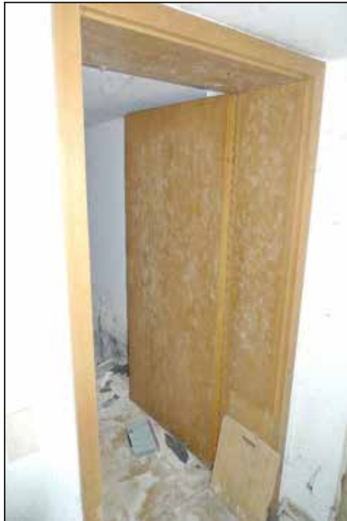
Abbildung 68 Feuchtigkeits und Schimmel an den Innentüren fotografiert am 24.01.2025
