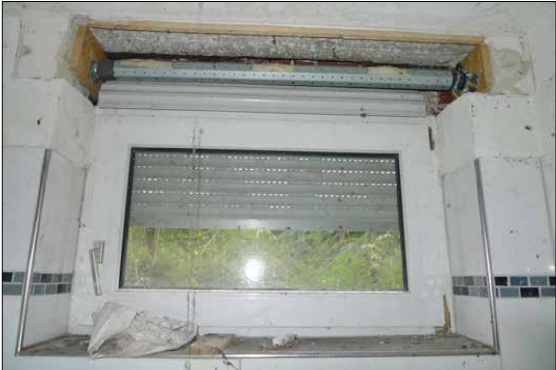
Abbildung 66 defekte Rollläden und aufgebrochener Rollladenkasten fotografiert am 24.01.2025
