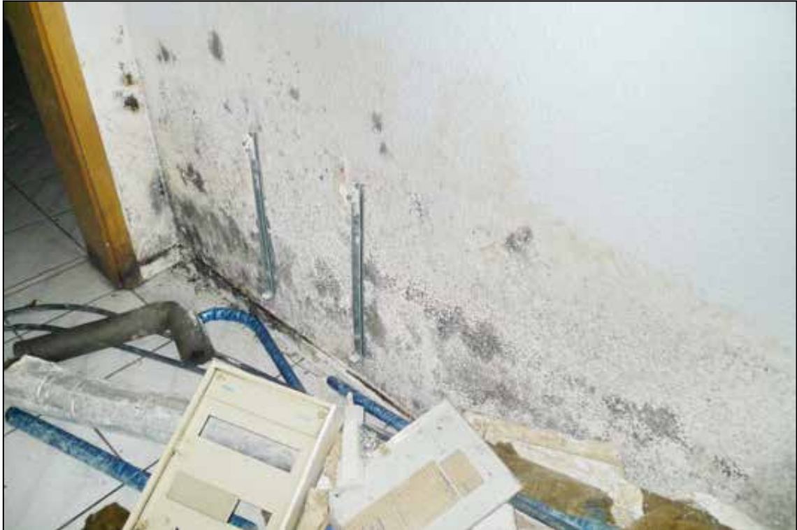
Abbildung 63 Feuchte und Schimmel im unteren Wandbereich der gesamten Wohnung fotografiert am 24.01.2025
