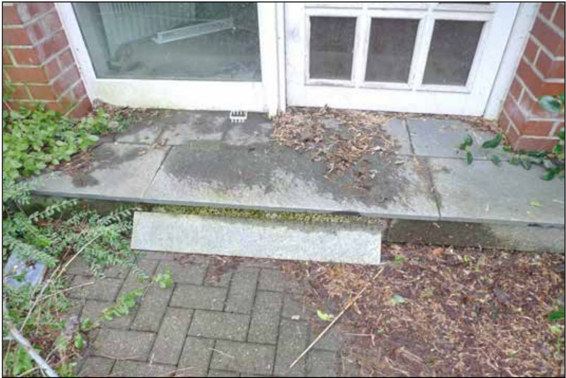
Abbildung 28 Beschädigungen des Oberbodenbelags der Differenzausgleichsstufe fotografiert am 24.01.2025
