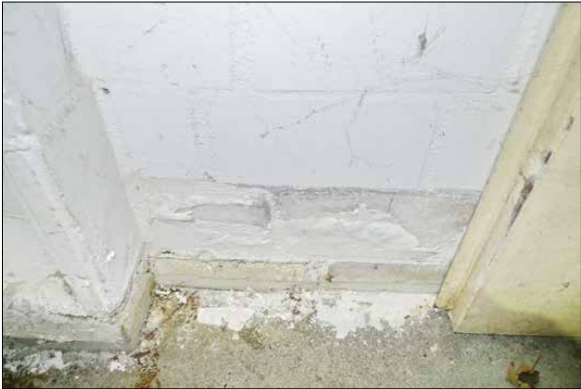
Abbildung 40 Feuchtigkeit im gesamten Kellergeschoss fotografiert am 24.01.2025
