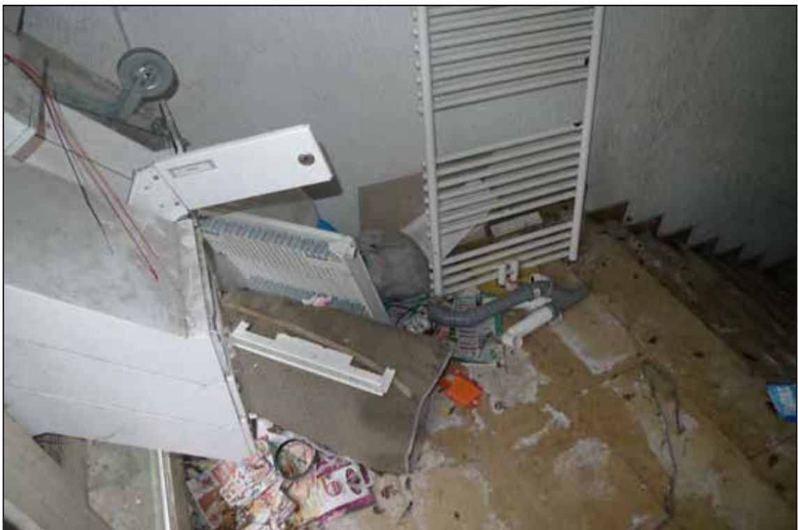
Abbildung 33 demolierte Briefkastenanlage, Feuchtigkeiterscheinungen am Fußbodenoberbelag fotografiert am 24.01.2025
