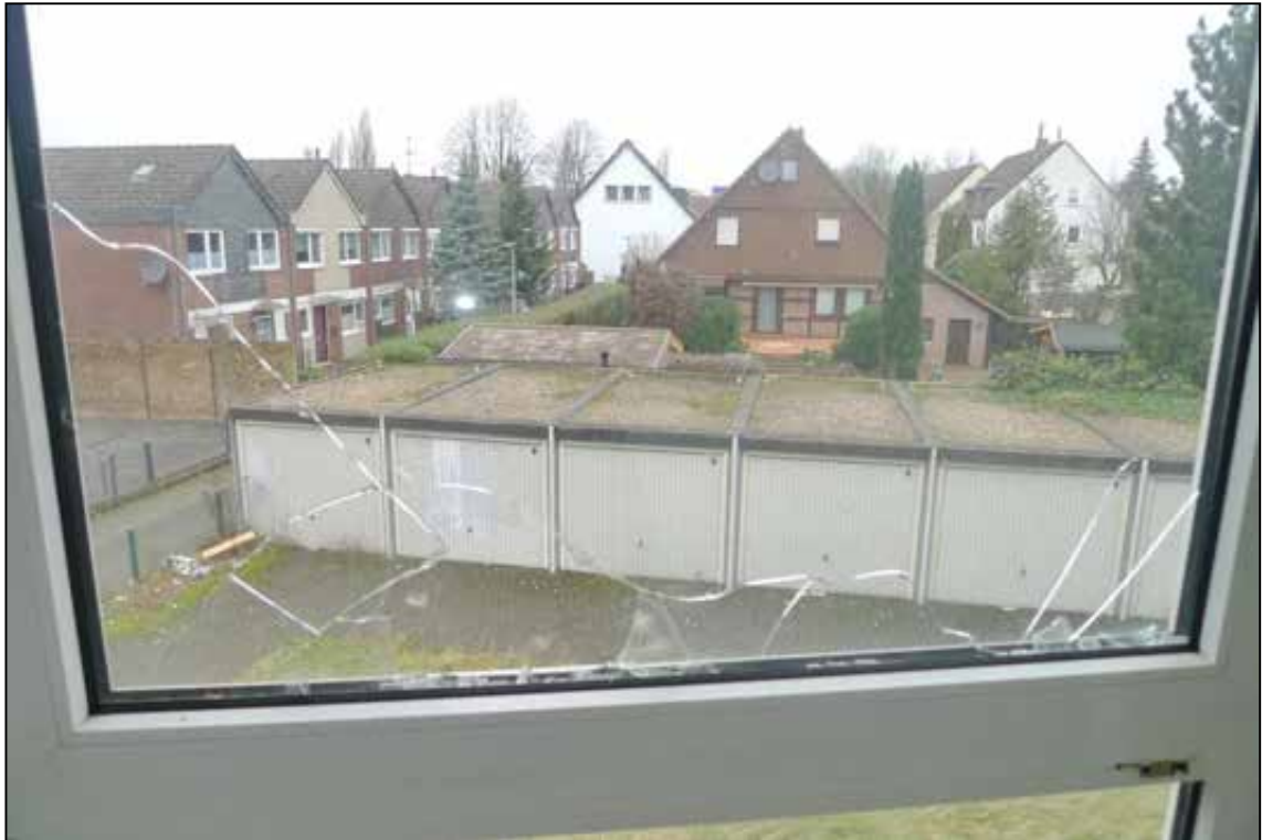
Abbildung 67 zerstörtes Fensterglas fotografiert am 24.01.2025
