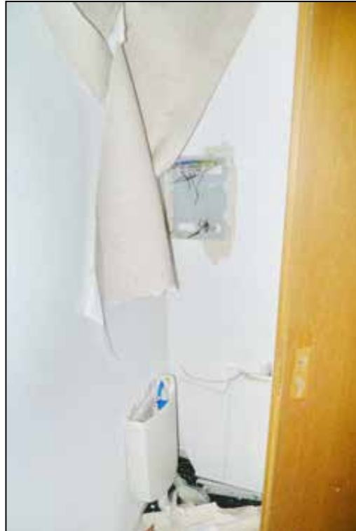
Abbildung 64 demontierter Sicherungskasten fotografiert am 24.01.2025
