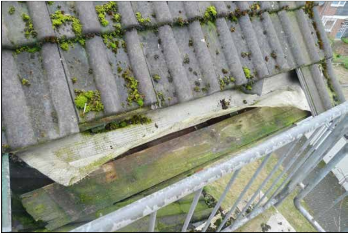
Abbildung 42 fehlende Dachsteine fotografiert am 24.01.2025
