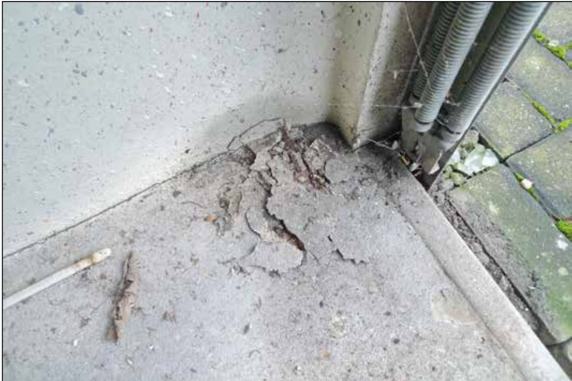
Abbildung 58 Betonschaden an der Bodenplatte der Garage fotografiert am 24.01.2025
