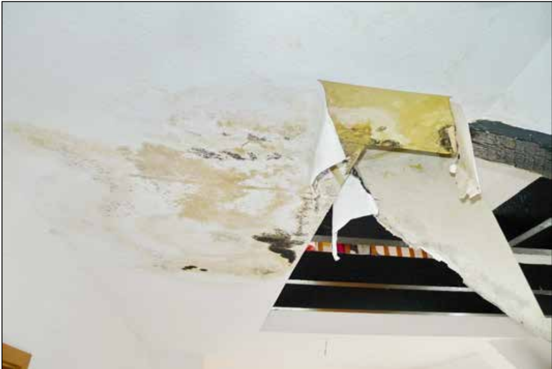
Abbildung 69 Feuchtigkeits und Schimmel an der Decke fotografiert am 24.01.2025
