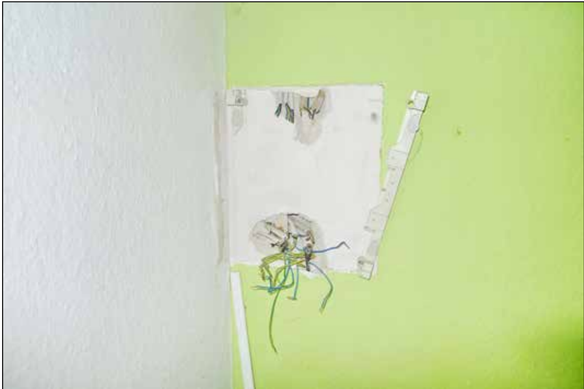
Abbildung 66 demontierter Sicherungskasten fotografiert am 24.01.2025
