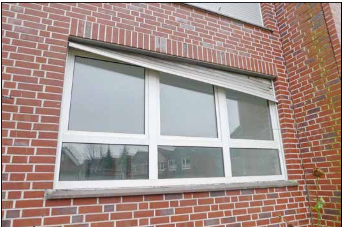
Abbildung 29 defekte Rollläden an mehreren Fenstern fotografiert am 24.01.2025
