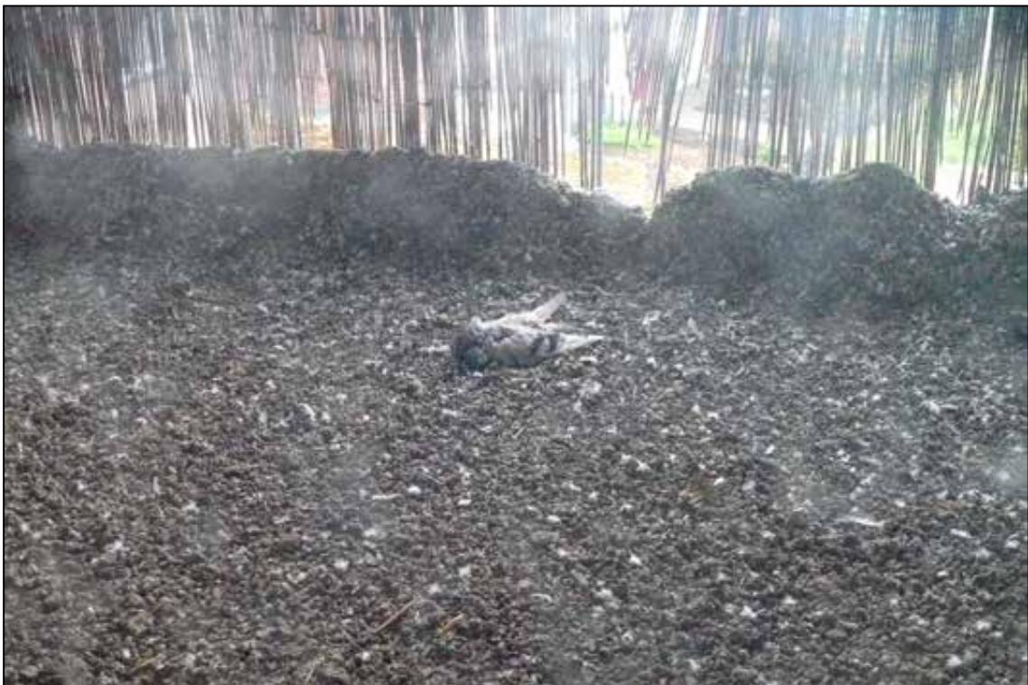
Abbildung 70 Balkon komplett belegt mit Vogelkot, Spritzen und Kadavern fotografiert am 24.01.2025
