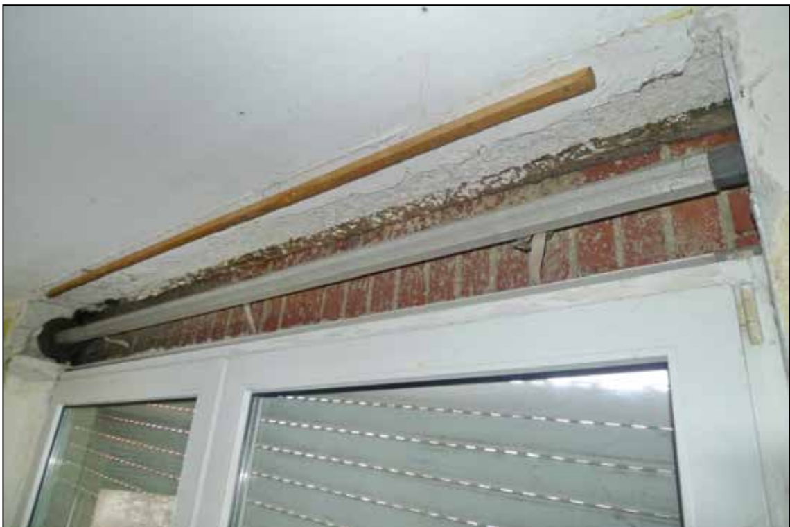
Abbildung 70 defekte Rollläden und aufgebrochener Rollladenkasten fotografiert am 24.01.2025
