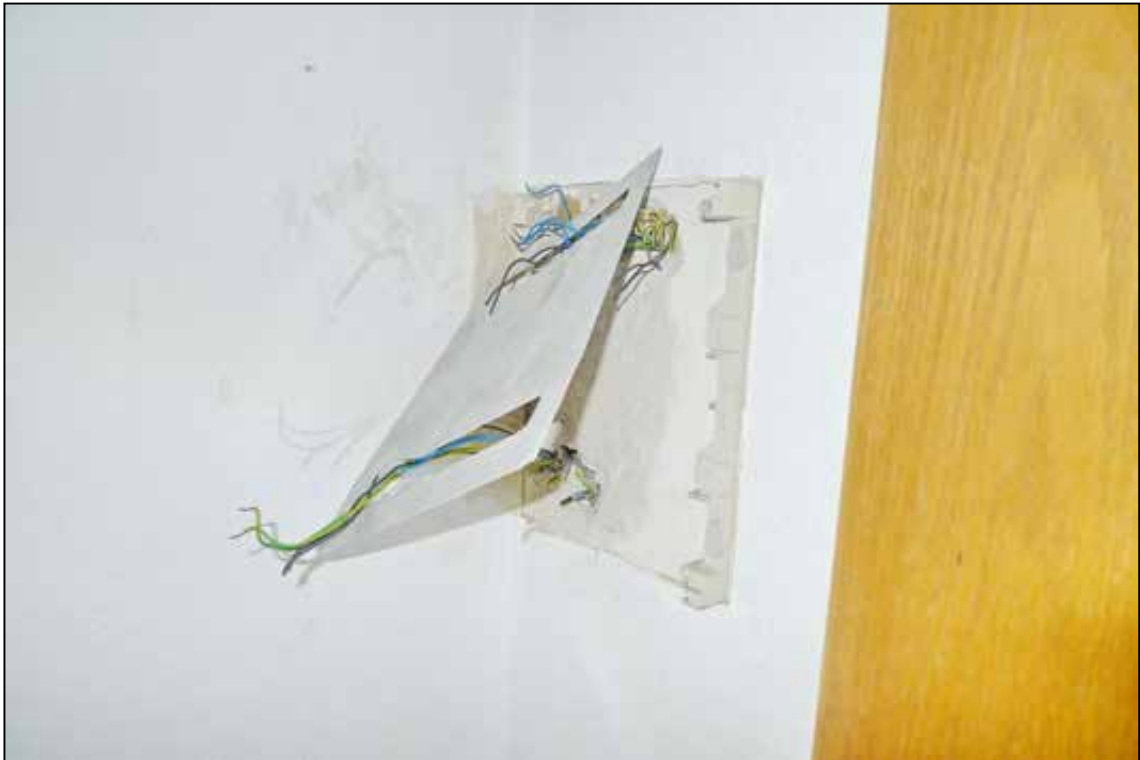
Abbildung 67 demontierter Sicherungskasten fotografiert am 24.01.2025
