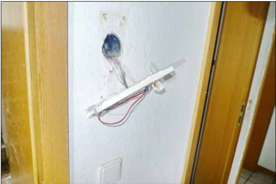
Abbildung 68 demontierte Gegensprechanlage fotografiert am 24.01.2025
