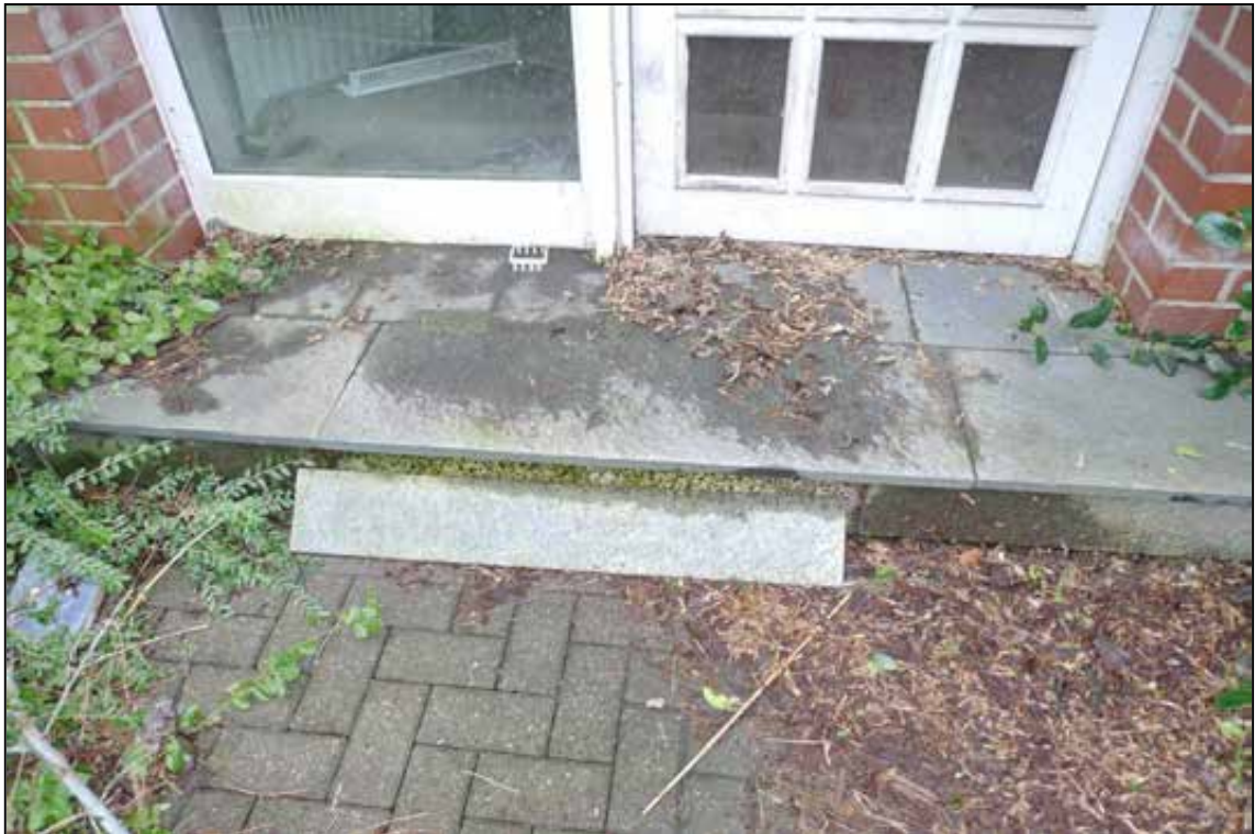
Abbildung 28 Beschädigungen des Oberbodenbelags der Differenzausgleichsstufe fotografiert am 24.01.2025
