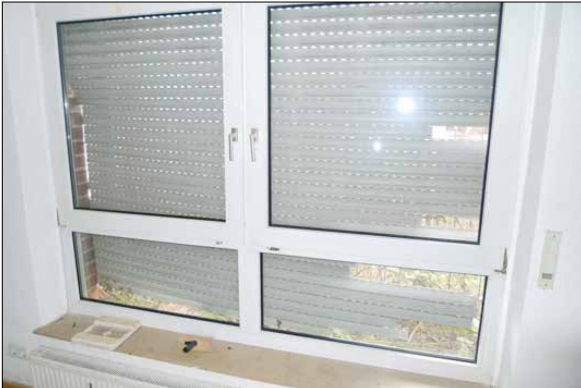
Abbildung 71 defekte Rollläden fotografiert am 24.01.2025
