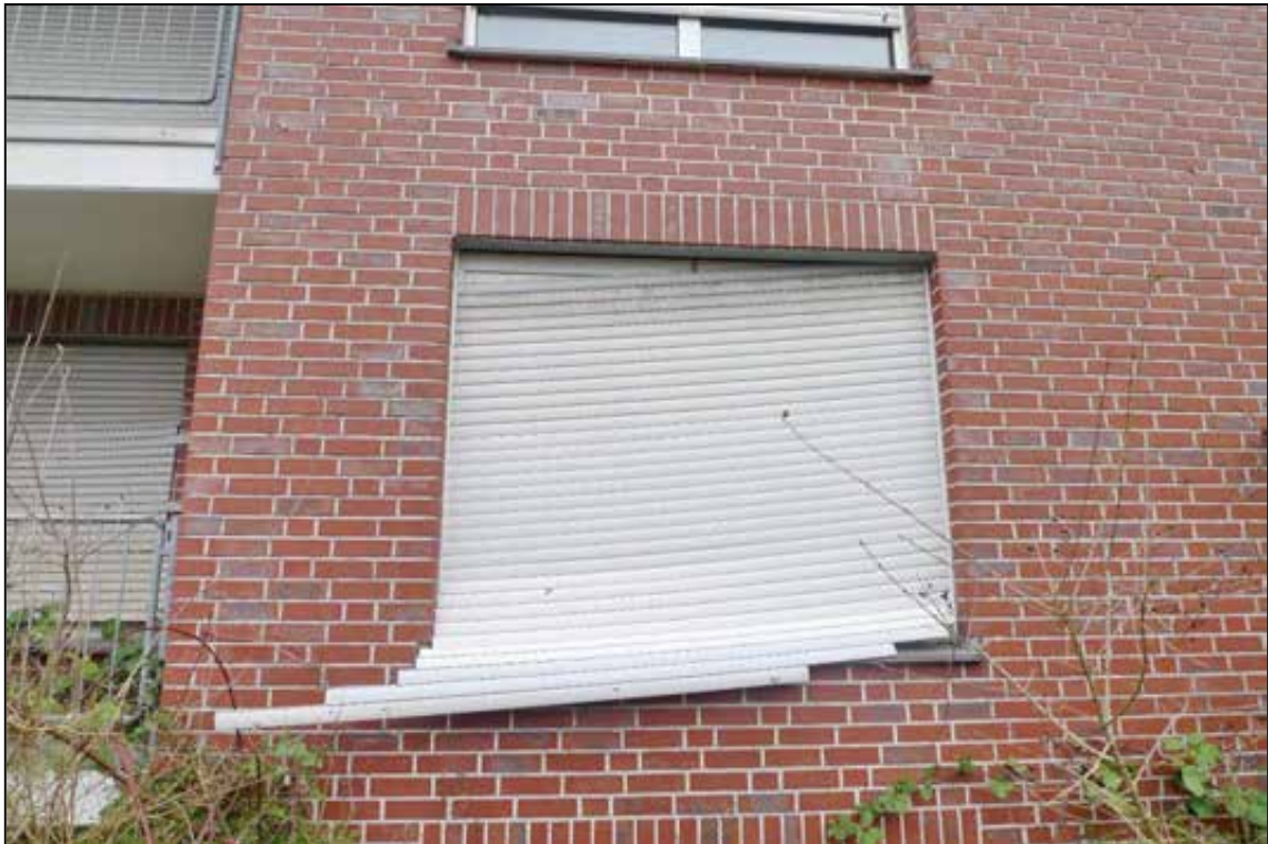
Abbildung 30 defekte Rollläden an mehreren Fenstern fotografiert am 24.01.2025
