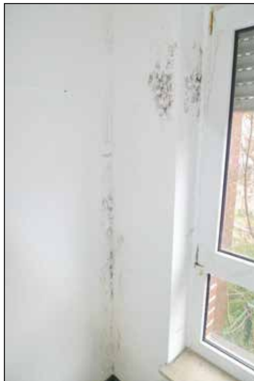
Abbildung 72 Feuchtigkeit und Schimmel an der Außenwand und im Fensterbereich fotografiert am 24.01.2025
