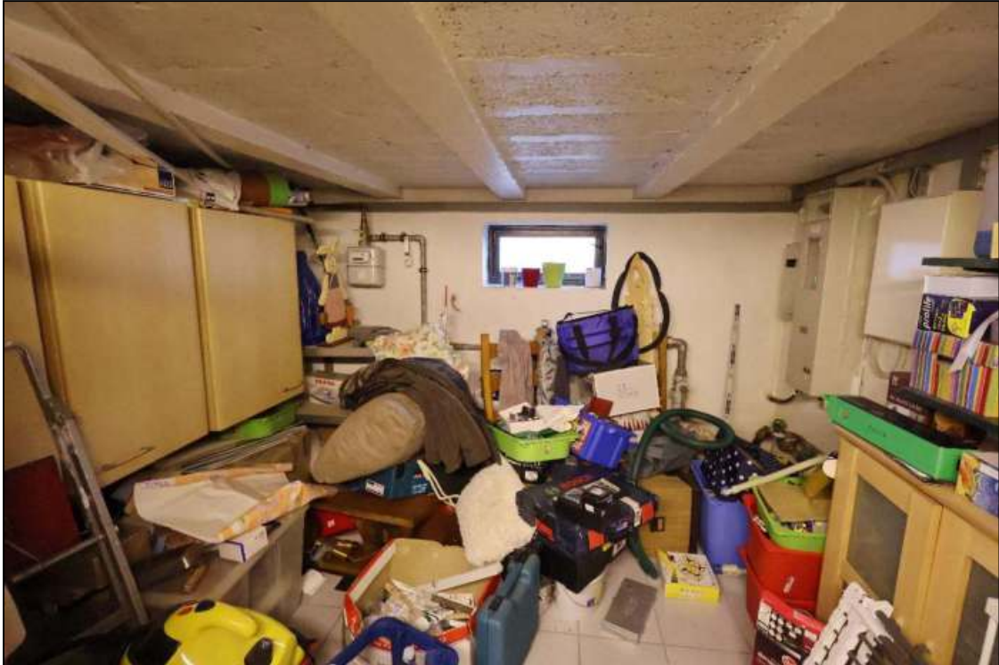
Abbildung 13 Abstell- und Hausanschlussraum im Kellergeschoss Foto Nr. 8, fotografiert am 21.01.2026
