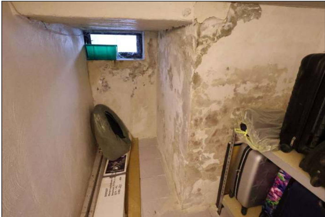
Abbildung 33 Feuchtigkeitserscheinungen an den Außenwänden im Kellergeschoss Foto Nr. 24, fotografiert am 21.01.2026
