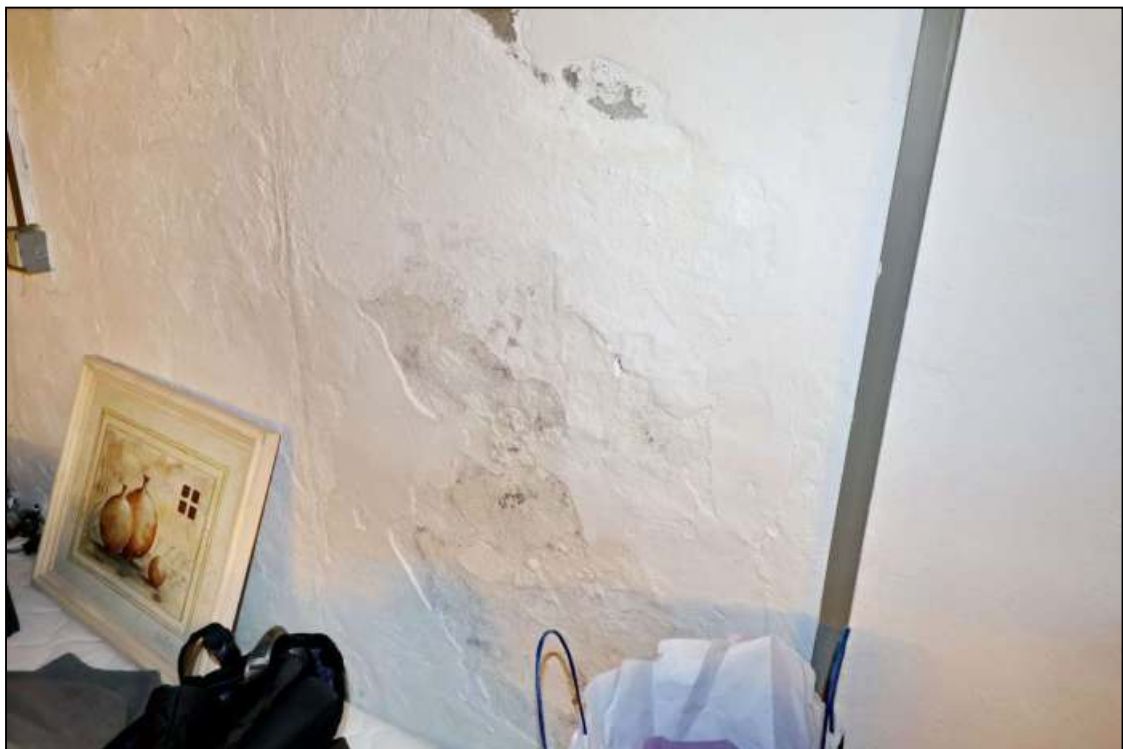
Abbildung 34 Feuchtigkeitserscheinungen an den Innenwänden im Kellergeschoss Foto Nr. 25, fotografiert am 21.01.2026
