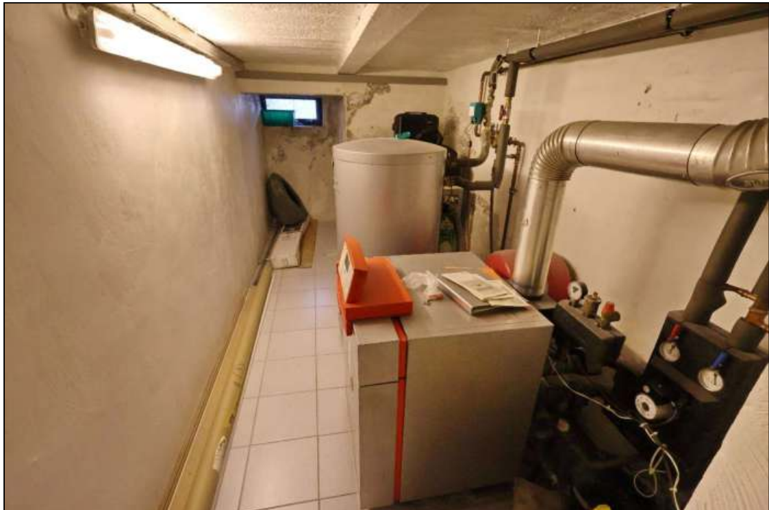
Abbildung 12 Heizungsraum im Kellergeschoss Foto Nr. 7, fotografiert am 21.01.2026
