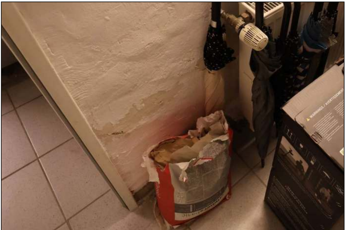
Abbildung 36 Feuchtigkeitserscheinungen an den Innenwänden im Kellergeschoss Foto Nr. 27, fotografiert am 21.01.2026
