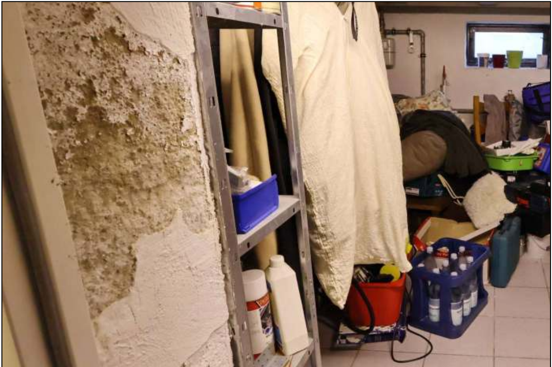
Abbildung 35 Putzabplatzungen an den Innenwänden im Kellergeschoss Foto Nr. 26, fotografiert am 21.01.2026
