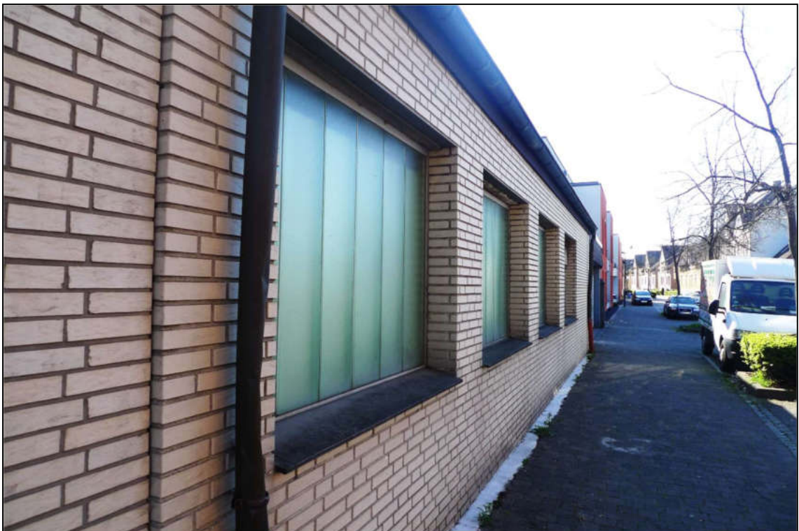
Abbildung 21 Beschädigtes Fallrohr am Wohn- und Geschäftshaus fotografiert am 04.04.2025
