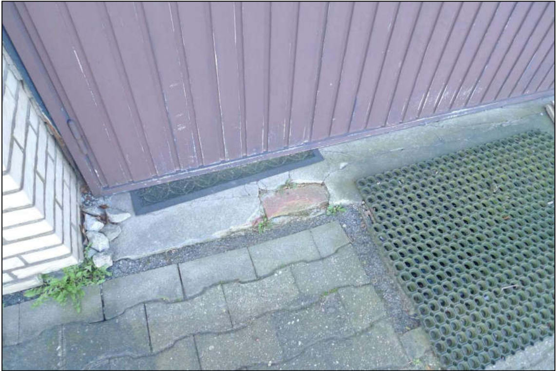
Abbildung 20 Abplatzungen am Estrich der Garage vom Wohn- und Geschäftshaus fotografiert am 04.04.2025
